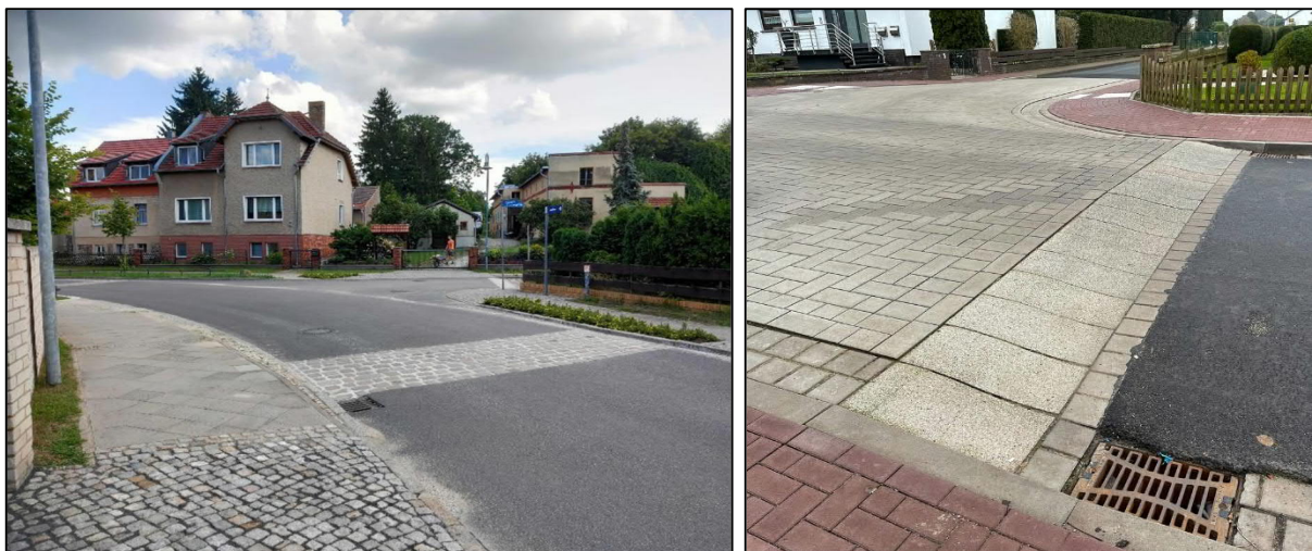
Abbildung 15: Fahrbahnanhebung im Kreuzungsbereich, Bilderquellen: Land Brandenburg (links), Rinteln Aktuell (rechts)
