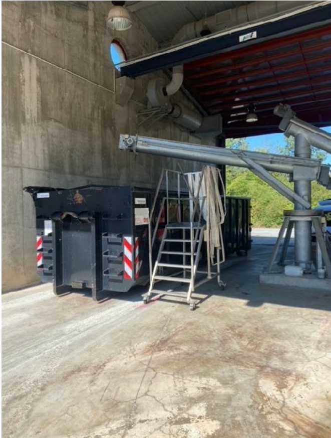
Abbildung 1: KA Ottendorf-Okrilla - Beladung der Klärschlammcontainer, Übergabestelle
