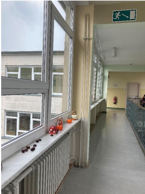
Fenster Flur, Kunststoff in Teilbereich
