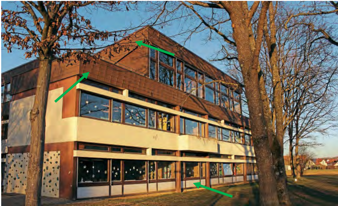
Übersicht (Pfeile mit Verdacht auf Asbestzement-Produkte)
