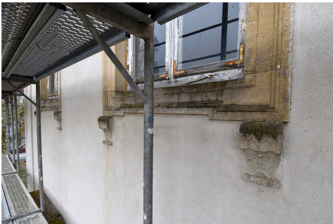
Abb. 22 Kernbau, Ostseite; südlicher Eckkrisalit, Obergeschoss, unterer Abschluss Fenster, Juni 2017
