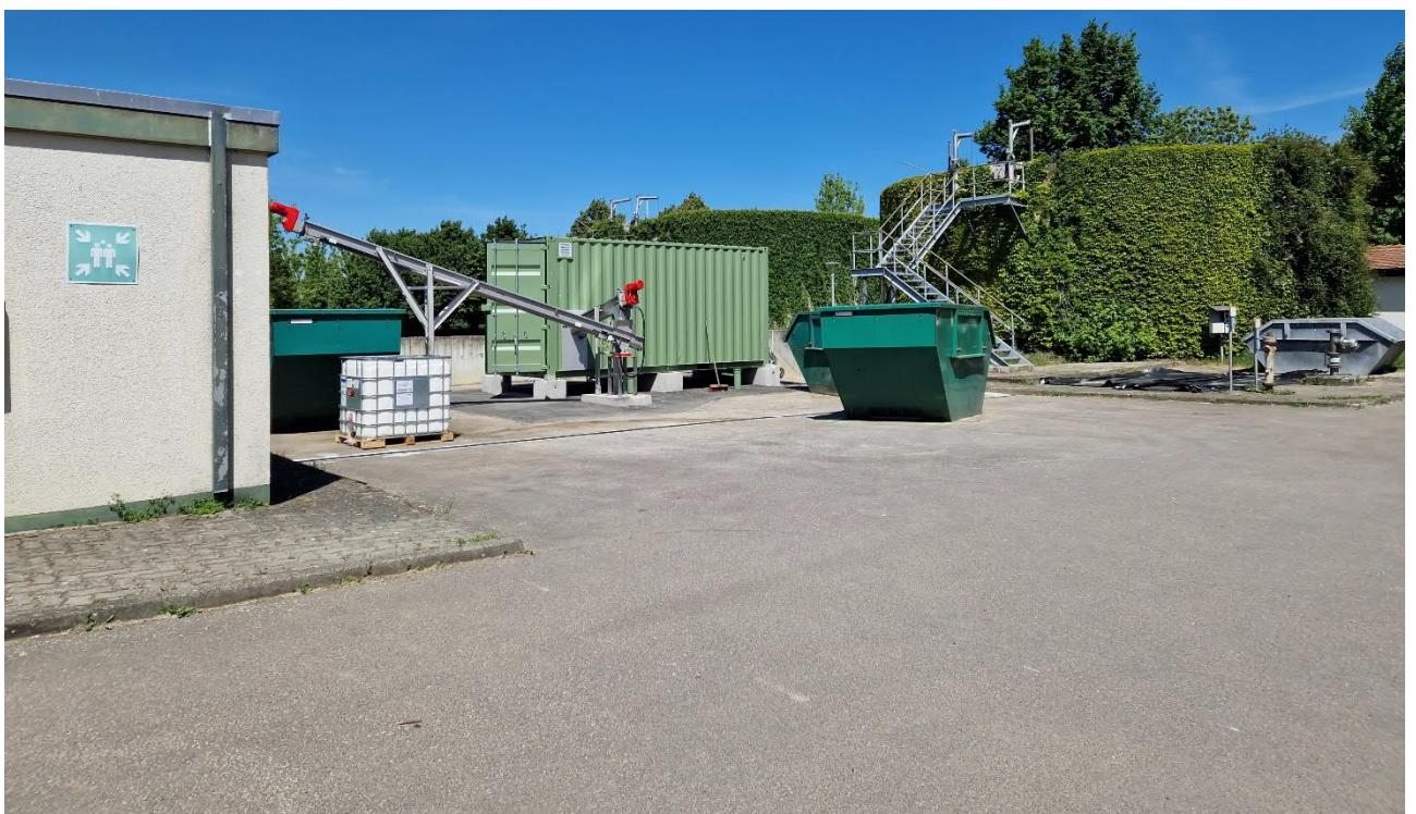
Abbildung 2: Container mit Maschinellem Schlammwässern, angebundenem Schwenkförderer und Aufstellung der Absetzcontainer für Schlammabwurf
