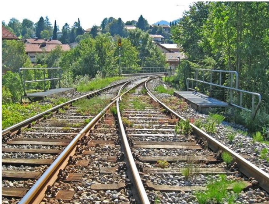
Abb. 9 EÜ Seeuferweg (km 7,822) - Blick in Richtung Stadt Tegernsee
