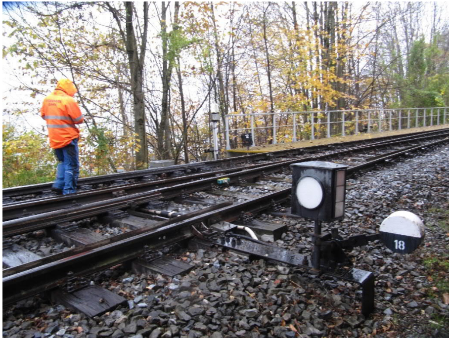
Abb. 105 Elektrische Weiche 12 mit Ortsbedieneinrichtung (km 12,06)
