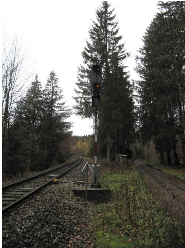
Abb. 97 Einfahrsignal B aus Richtung Gmund (km 0,510)
