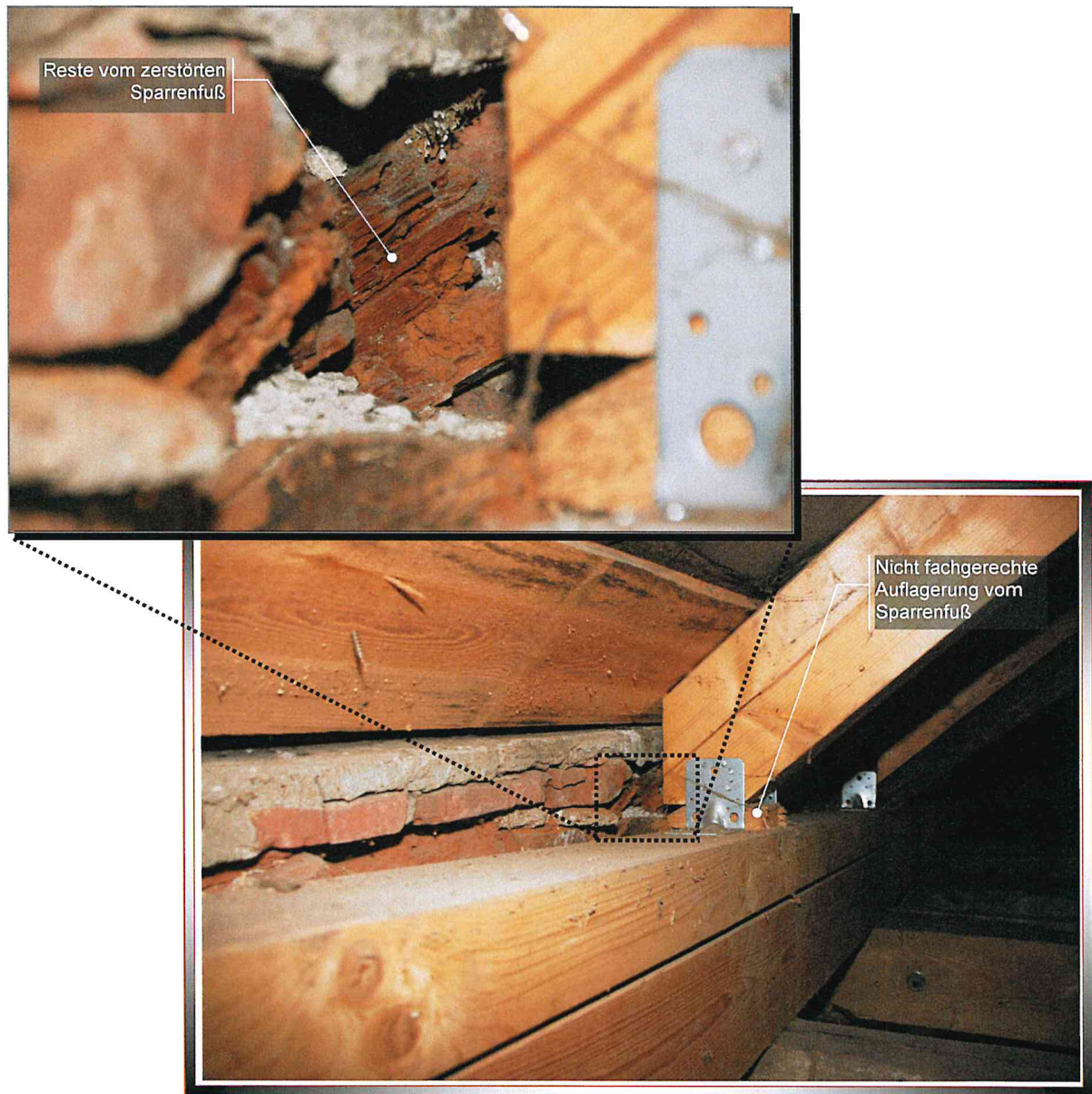
Bild 7 Zerstörtes Holz wurde bei der Sanierung nicht entfernt
