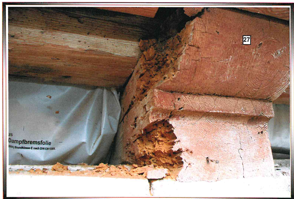
Bild 10 Hausbockfraßgänge im Splintholz vom Balkenkopf
