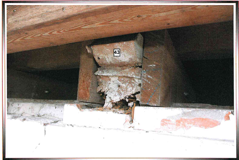
Bild 13 Balkenkopf mit Hausbockschäden und Anlaschungen
