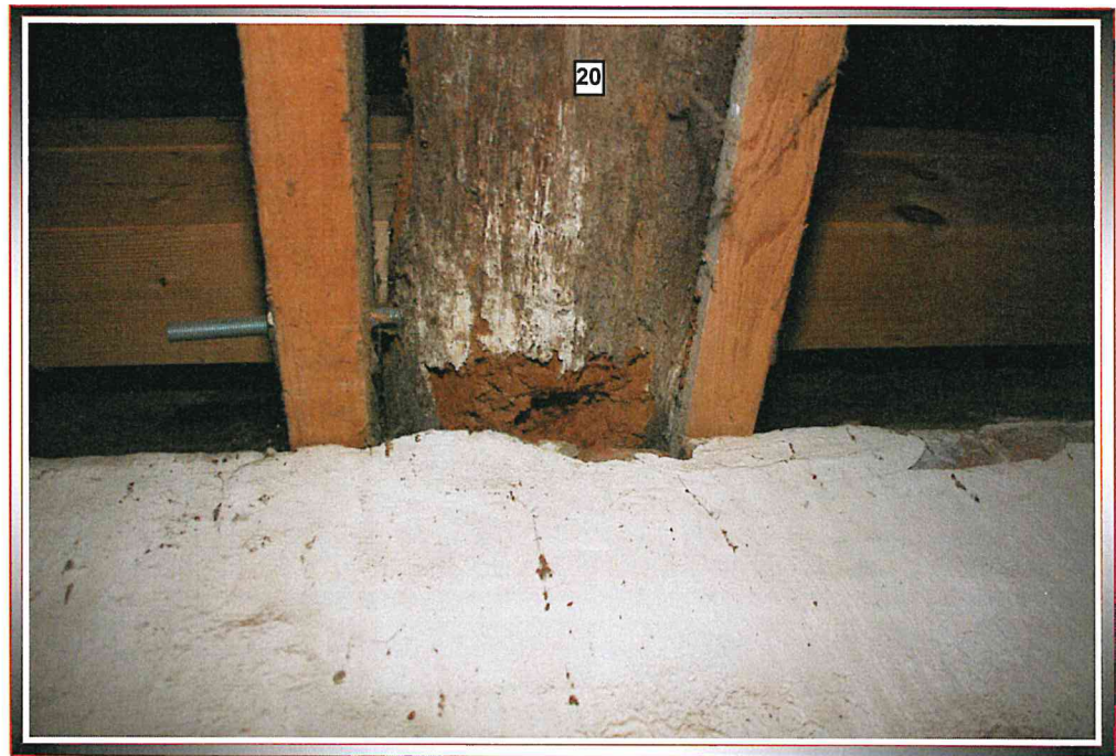
Bild 8 Komplette zerstörter und bereits angelaschter Balkenkopf
