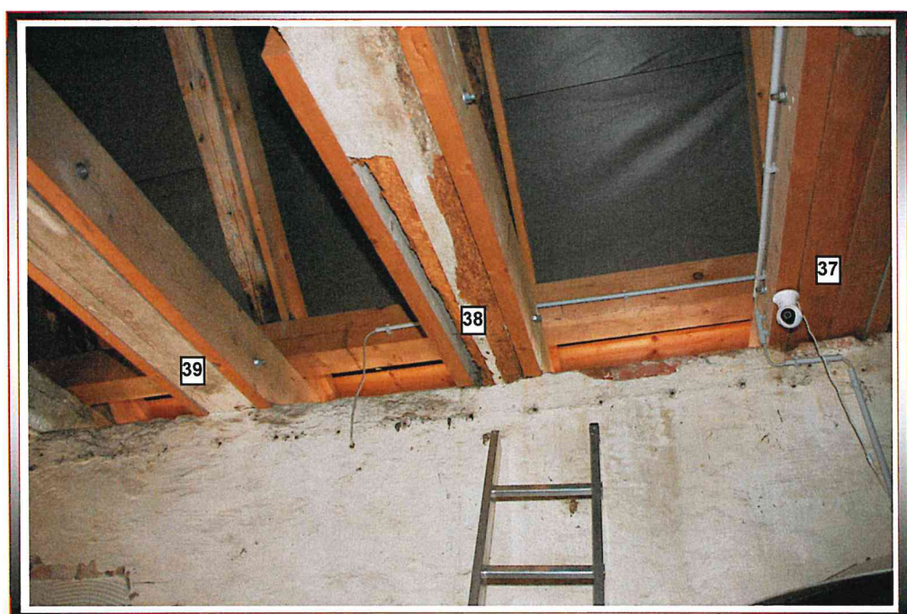
Bild 12 Bebeilungen und Anlaschungen an Balken auf der Ostseite
