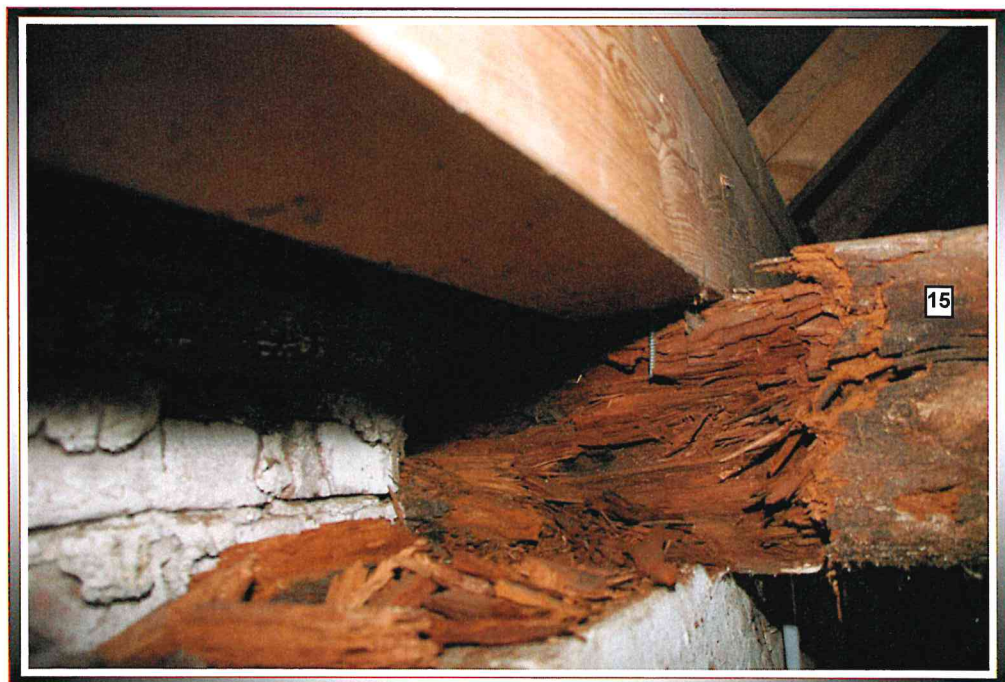
Bild 6 Balkenkopf ohne tragfähiger Holzsubstanz (Auflager 15)
