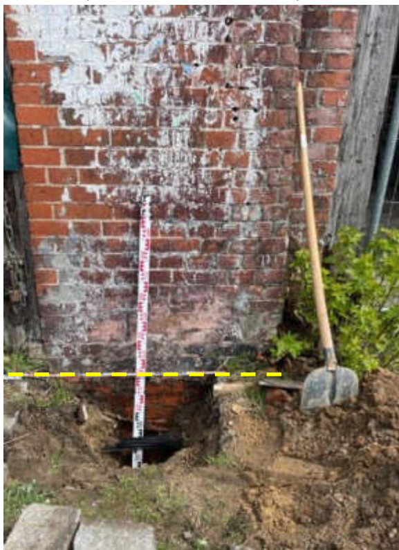
Abb. 5, Betonfundament 0,90 m unter OK Großpflaster, das Mauerwerk besitzt keine Abdichtung
