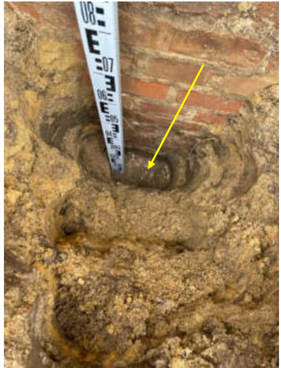
Abb. 2, Blick auf das vorspringende Streifenfundament, das Mauerwerk besitzt keine Abdichtung
