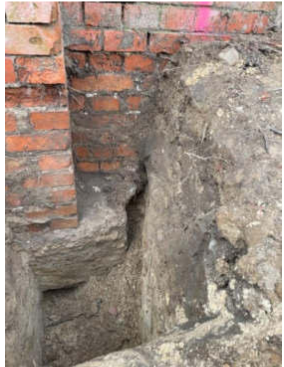
Abb. 4, Blick auf das vorspringende Streifenfundament, das Mauerwerk besitzt keine Abdichtung
