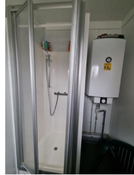
Dusche / Durchlauf- erhitzer
