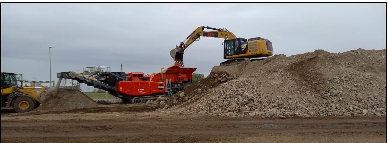
Abb. 7-20 Beispielfoto einer Brecheranlage
