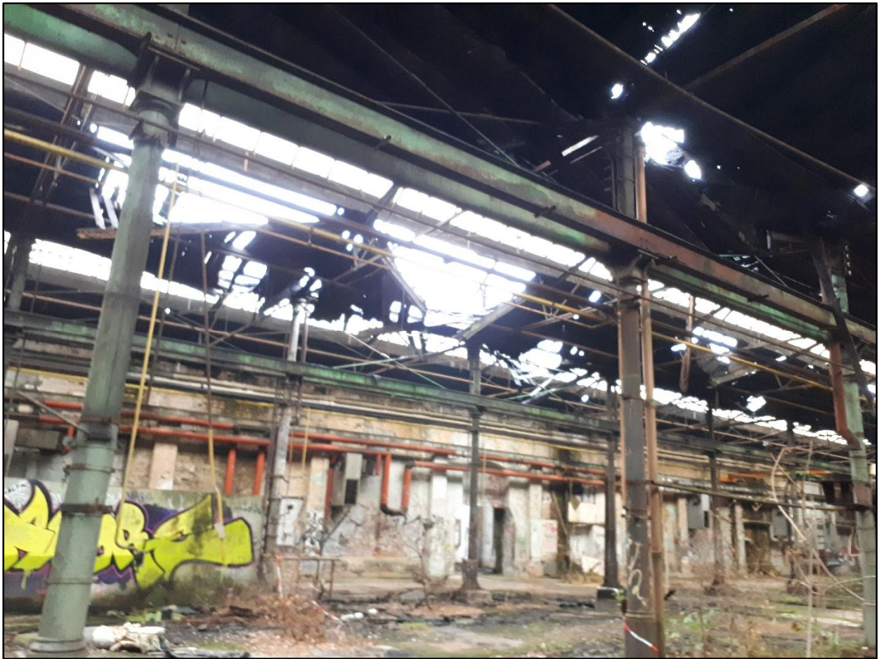
Abb. 2-9 Teileinsturz der Dachkonstruktion (24.01.2023)
