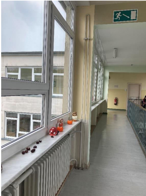
Fenster Flur, Kunststoff in Teilbereich
