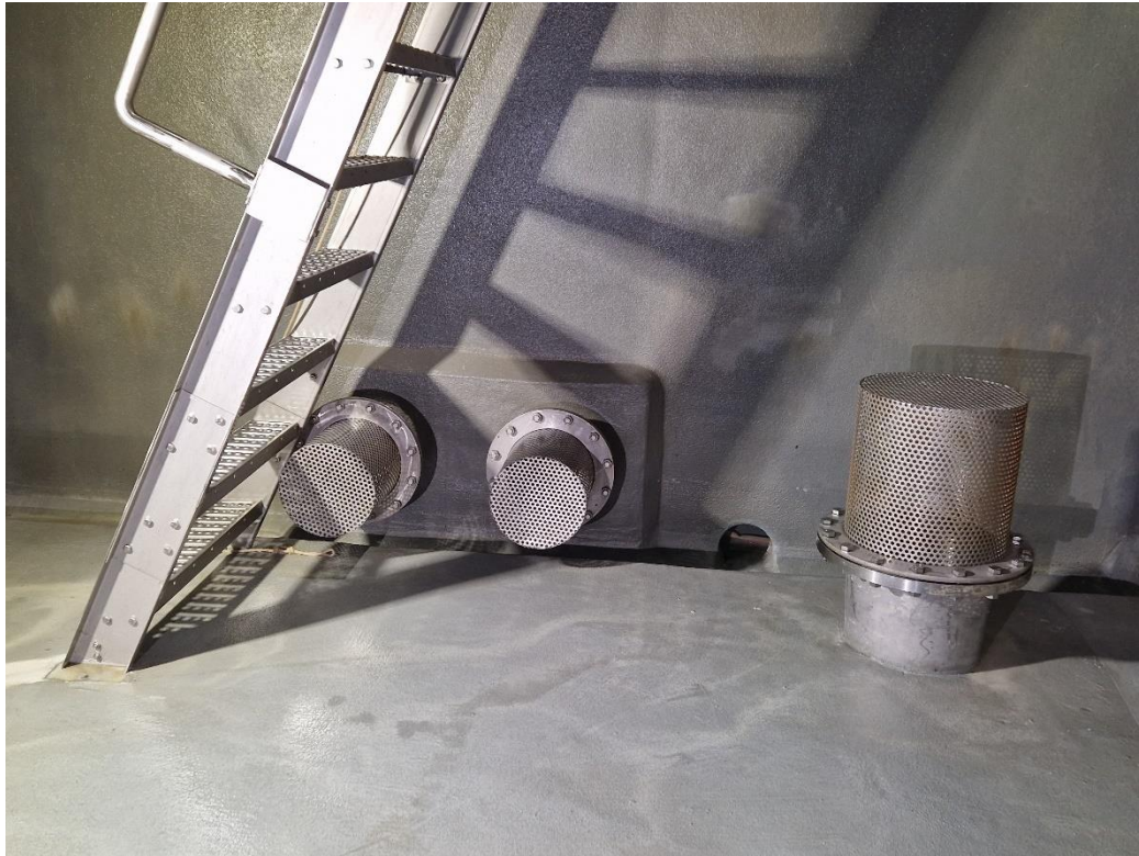
Abb. 19: 3 x Entnahme (2x Durchführung durch Trennwand - linke Wasserkammer)
