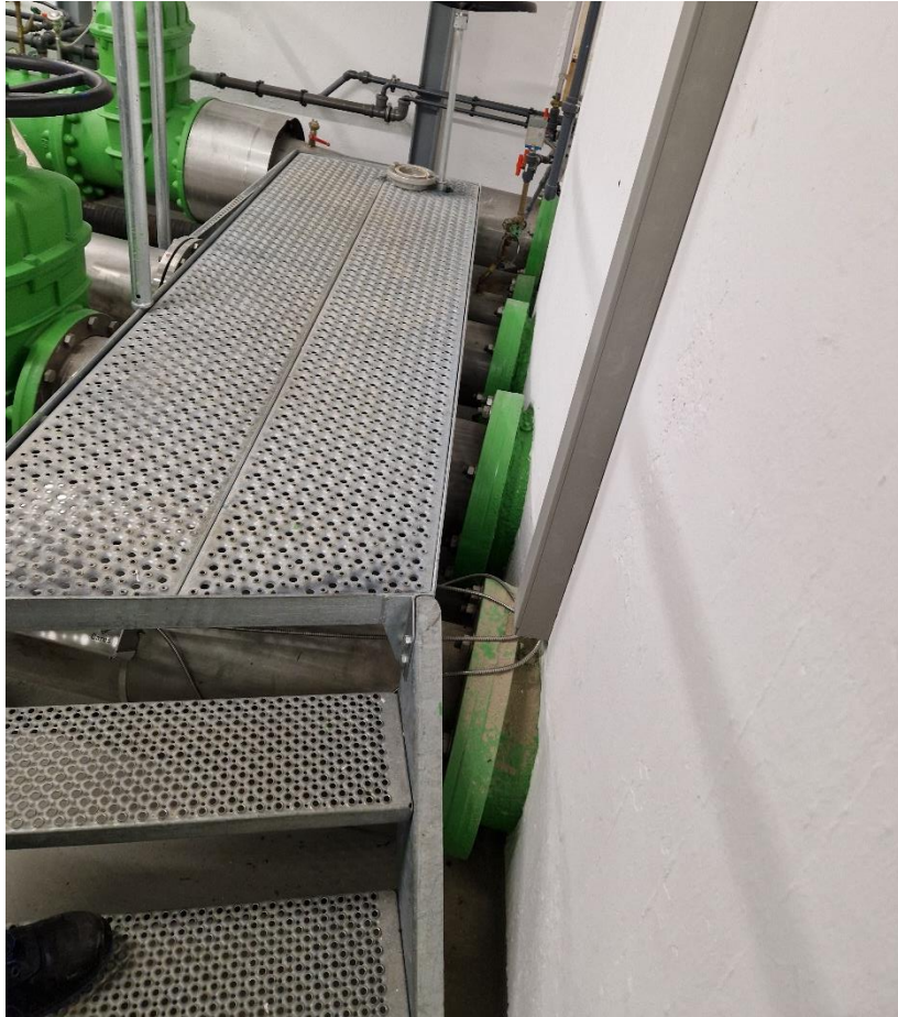
Abb. 27: 3 x Entnahme / Überlauf I in Vorkammer / Schieberkammer
