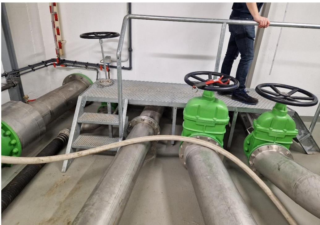
Abb. 28: 3 x Entnahme / Überlauf I in Vorkammer / Schieberkammer
