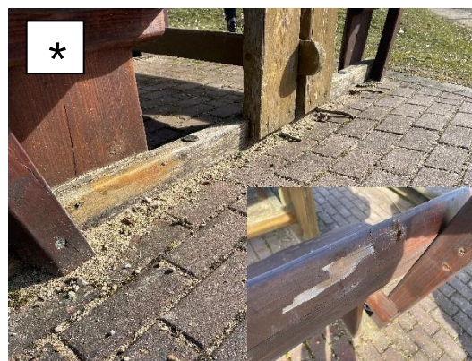
* Verankerung / Farbabplatzung erneuern
