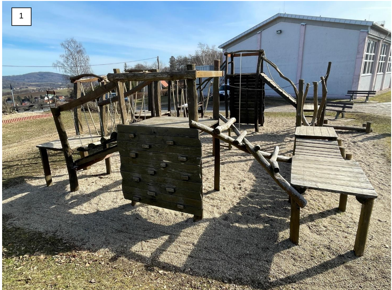
Kletterpfad 9m x 11m: 42 Stützen in Beton, Fallschutz neu 50/50, Höhe max. 3,50m → versetzen / ausbessern
