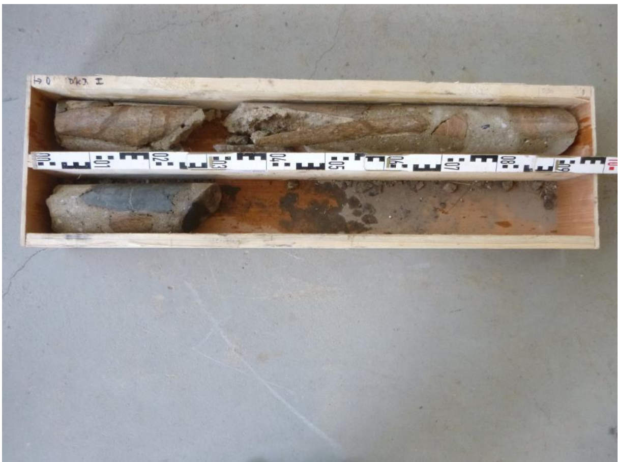
Detail Ansicht Betonbohrkern der Diamantkernbohrung (DKB) Nr. I
