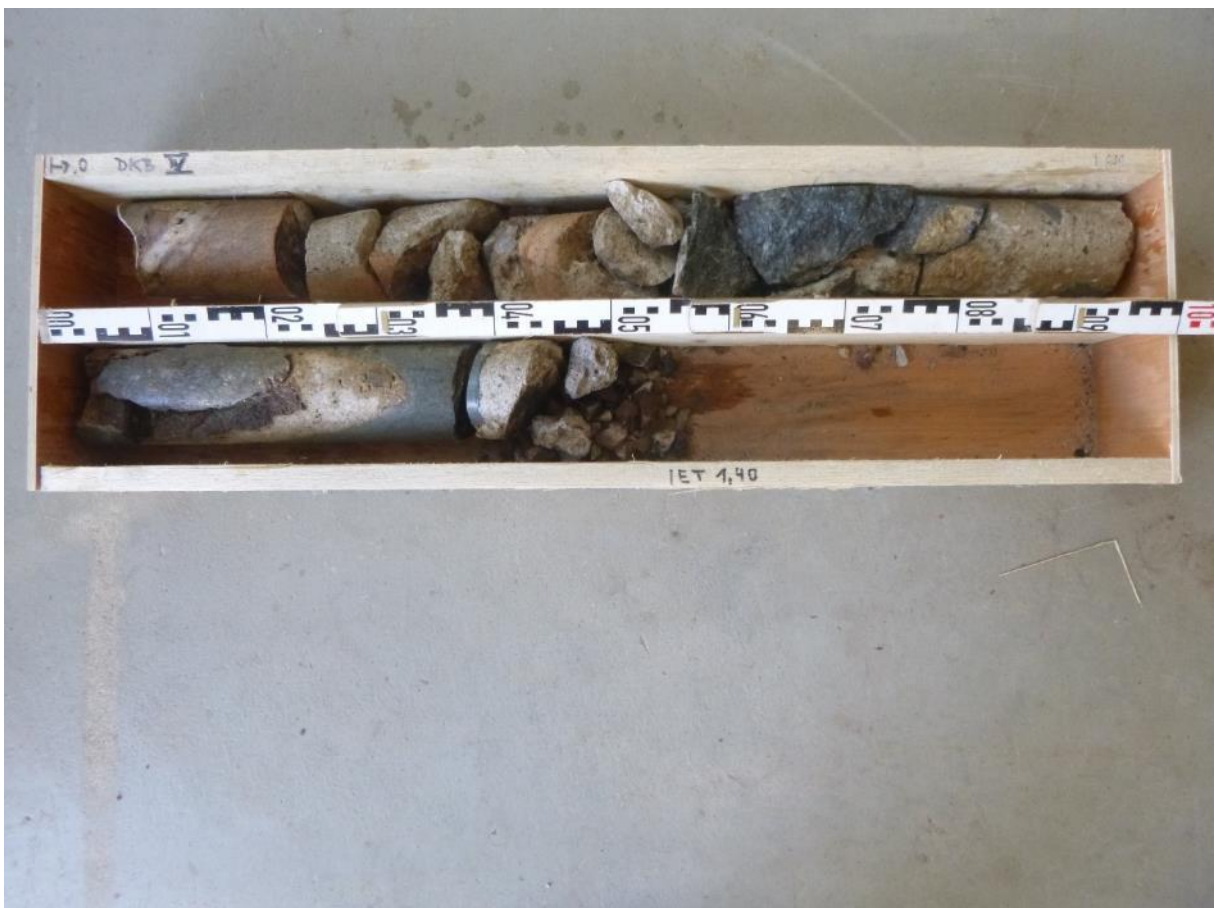
Detail Ansicht Betonbohrkern der Diamantkernbohrung (DKB) Nr. V
