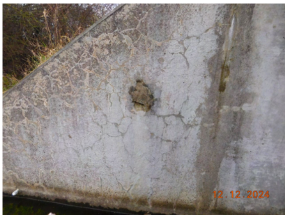
2024H-06_FLÜGEL HINTEN LINKS_ABPLATZUNG UND RISSE AN MÖRTEL
