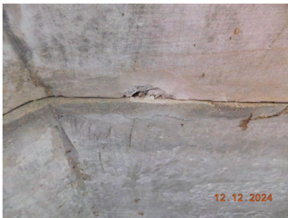
2024H-02_BETONABPLATZUNG IM FUGENBEREICH_OBEN_VEREINZELT
