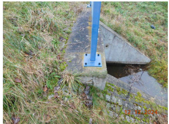
2024H-11_KAPPE HINTEN LINKS_SCHMUTZ IN ENTWÄSSERUNGSRINNE
