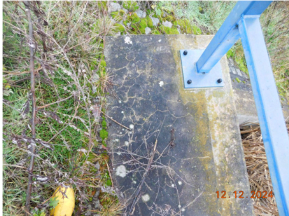
2024H-09_KAPPE RECHTS HINTEN OBEN_NETZRISSE
