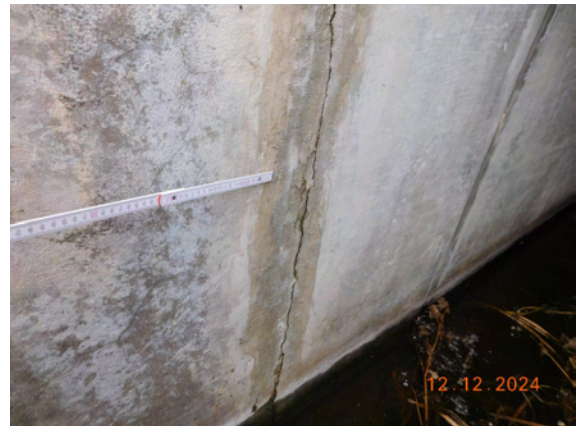
2024H-03_FUGE VORN RECHTS_GERISSEN
