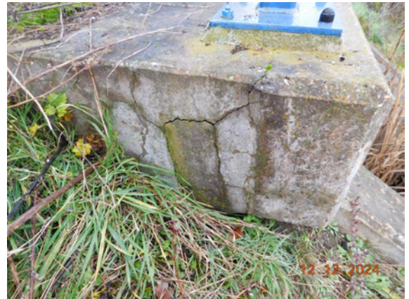
2024H-08_KAPPE RECHTS VORN_STIRNSEITE_RISSE
