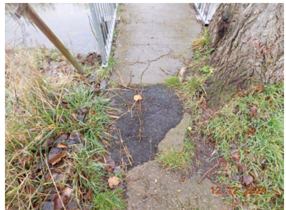
2024H-08_BELAG HINTEN AUF UND NACH BAUWERK_SCHADHAFT
