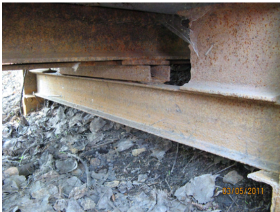
2011_AUFLAGERBALKEN OHNE KORROSIONSSCHUTZ
