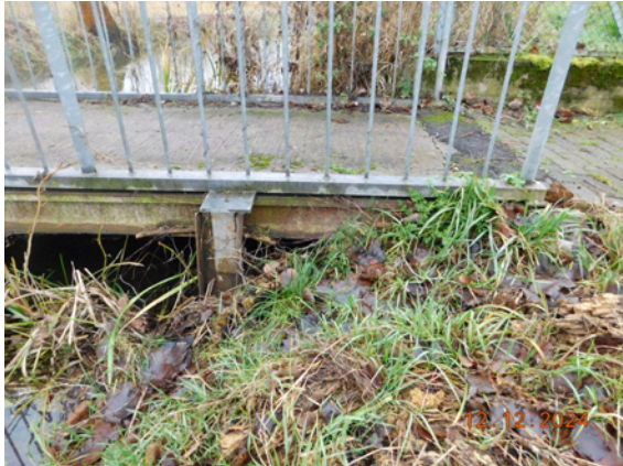
2024H-02_WIDERLAGER VORN LINKS STAHLPROFILE OHNE KORROSIONSSCHUTZ
