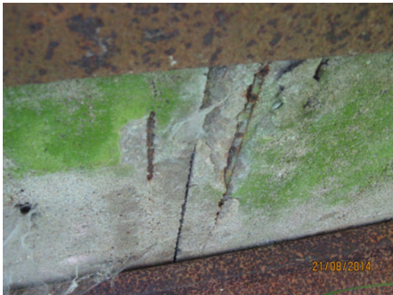
2014H_02_HOHLDIELEN LINKS BETON ABGEPLATZT FREILIEGENDE BEWEHRUNG DURCHFEUCHTET
