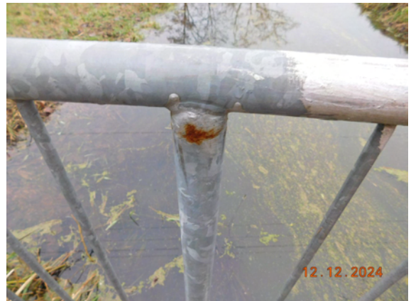
2024H-04_GELÄNDER LINKS MITTE_ROSTSTELLE
