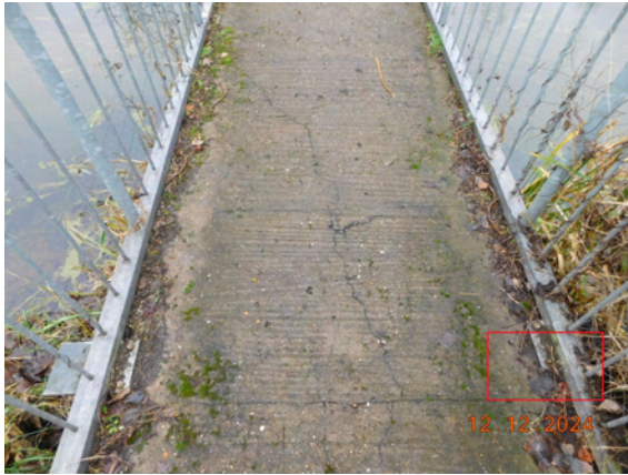
2024H-05_GELÄNDERVERANKERUNG RECHTS VORN_MÜTTER FEHLT
