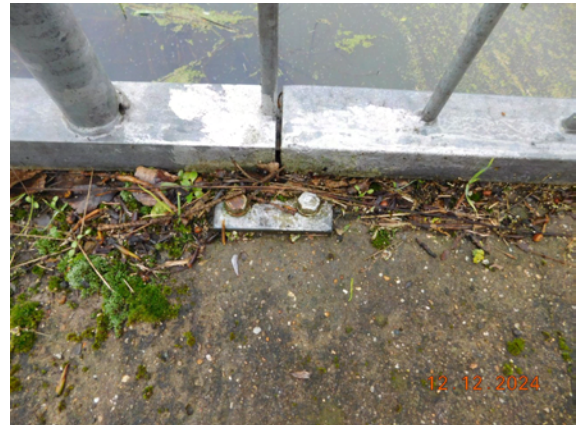
2024H-07_BELAG ENTLANG GELÄNDER_SCHMUTZ
