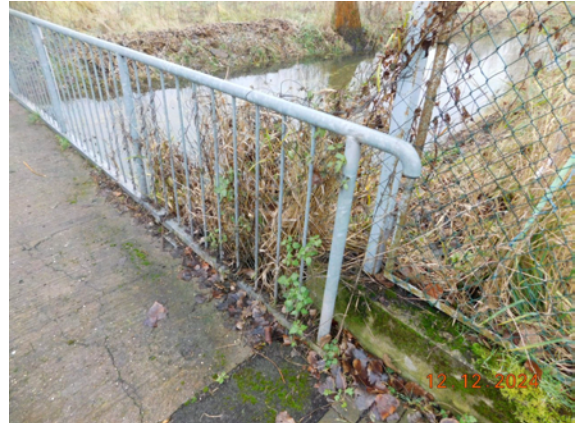
2024H-03_GELÄNDER VORN RECHTS_BEWUCHS
