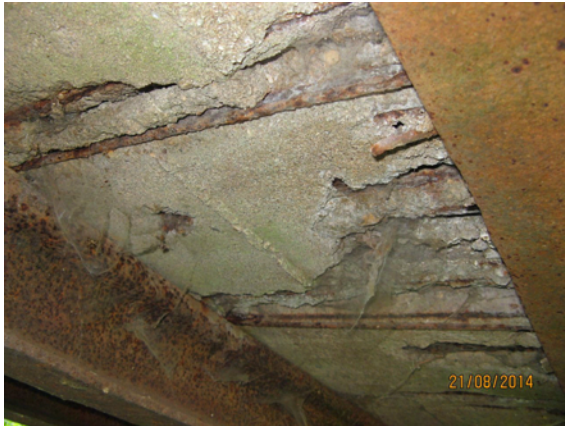
2014H_01_PLATTE MITTE UNTERSEITE BETON ABGEPLATZT FREILIEGENDE BEWEHRUNG
