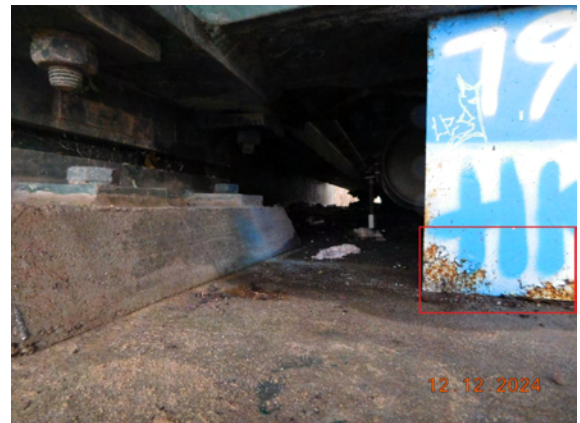
2024H-15_VORN RECHTS_BLECH ANGEROSTET
