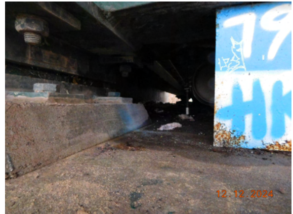
2024H-06_AUFLAGERBANK WIDERLAGER VORN VERSCHMUTZT MÜLL
