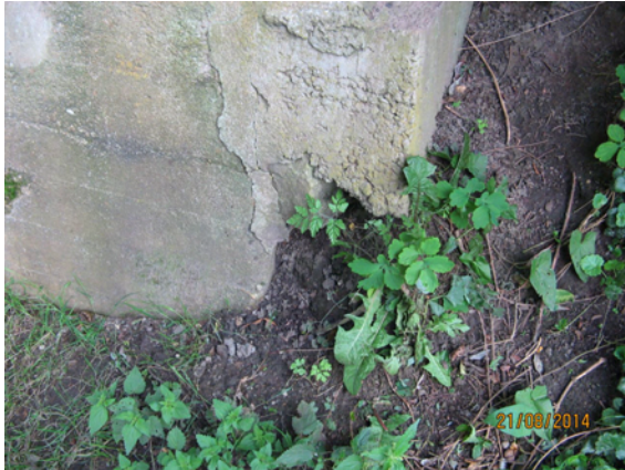
2014H_22_WIDERLAGER HINTEN RECHTE BETON ABGEPLATZT
