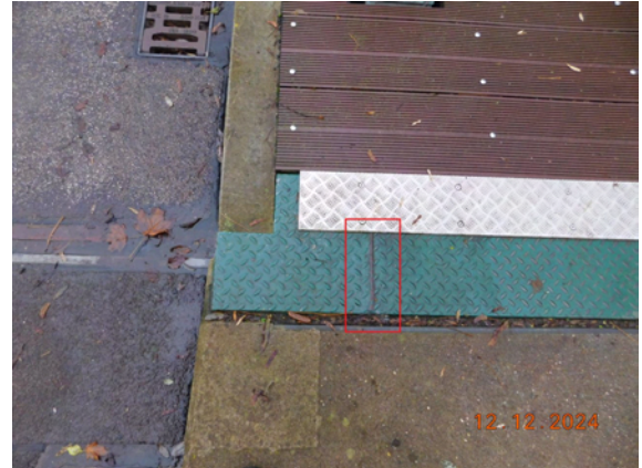
2024H-09_BLECH_FUGE VORN RECHTS_SCHMUTZ_ROST
