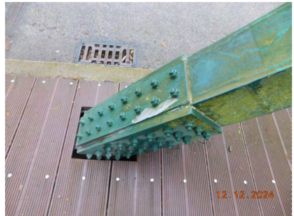
2024H-01_VORN RECHTS_FACHWERK UNTEN_ABPLATZUNG DECKSCHICHT
