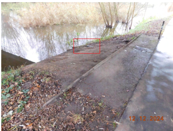
2024H-17_AUSLAUF VORN MITTE ROHR BESCHÄDIGT
