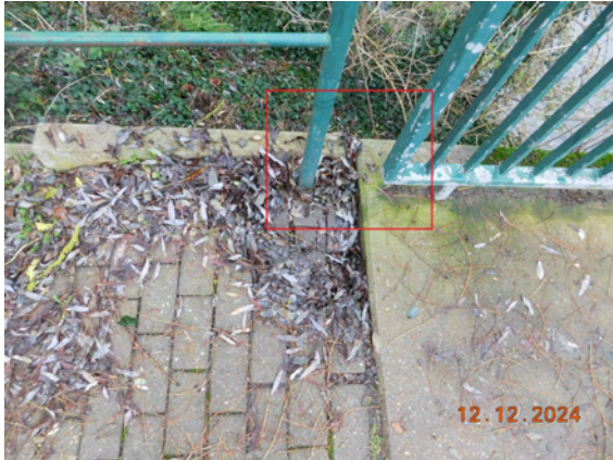
2024H-07_FUGE FERTIGTEIL - WIDERLAGER - HINTEN RECHTS - VERSATZ 1-3 CM
