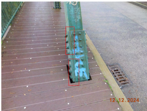
2024H-24_KONSTRUKTION LINKS VORN_FÄRBE ABLÖSEND
