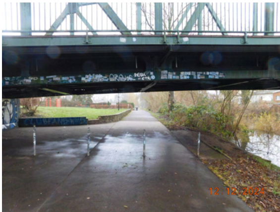
2024H-04_RECHTS VORN WEG_EINSCHRÄNKUNG LICHTRAUMPROFIL NICHT GEKENNZEICHNET
