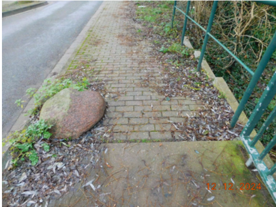
2024H-19_GEWEGBELAG HINTEN RECHTS_VERSCHMUTZT_BEWUCHS
