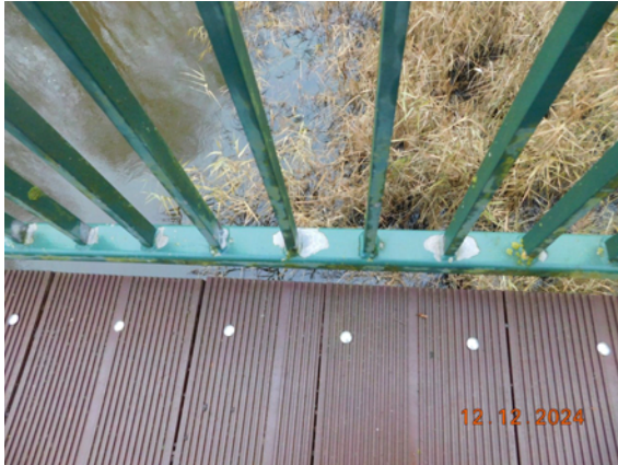
2024H-16_GELÄNDER RECHTS_UNTEN_ABPLATZUNG DECKSCHICHT AN FUSSLEISTE
