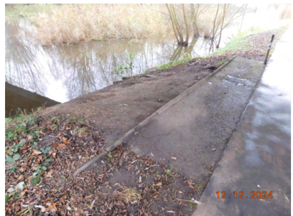
2024H-05_BÖSCHUNGSBEFESTIGUNG VORN FEHLT
