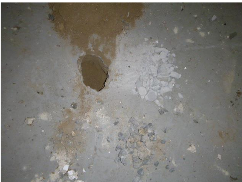
Bild 17: Ansicht Fußbodenestrich ohne Sperrschicht
