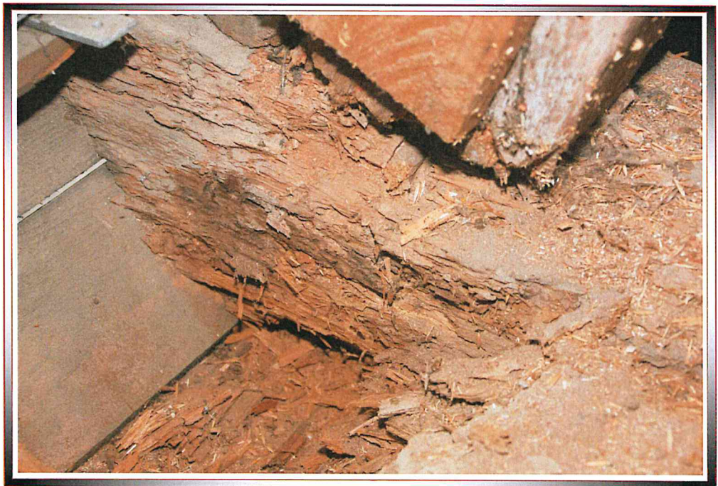
Bild 9 Weißfäule an einem Balkenkopf
