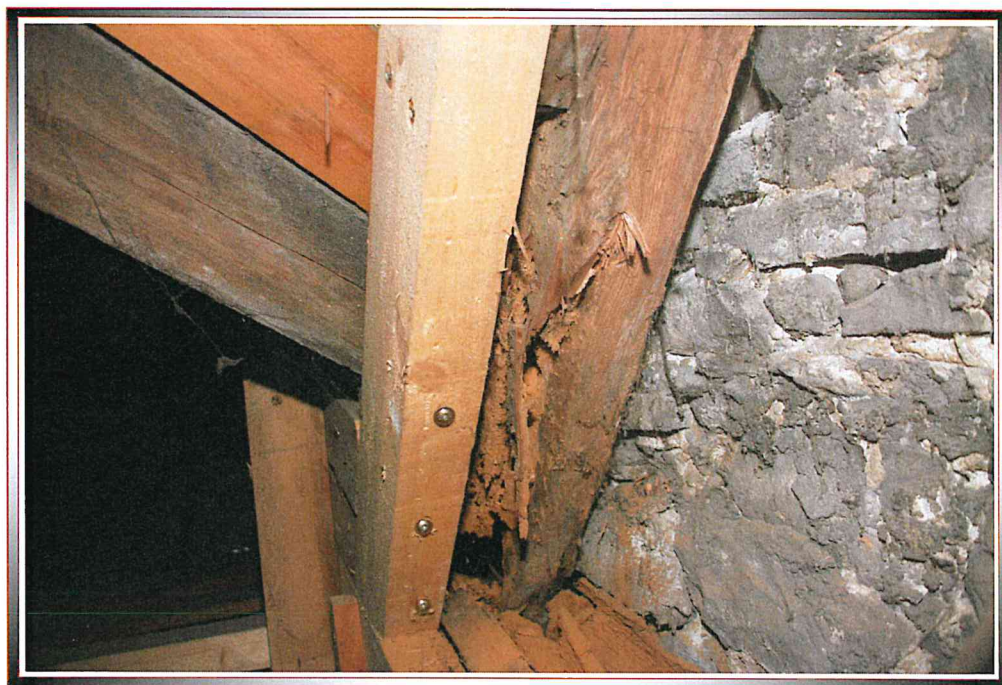
Bild 21 Komplett zerstörter Sparren mit Anlaschung
