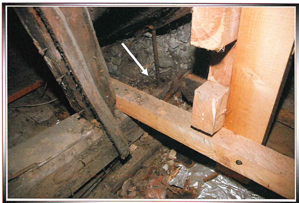
Bild 17 Fäulnisschäden am Auflager vom Überzug (Pfeil)
