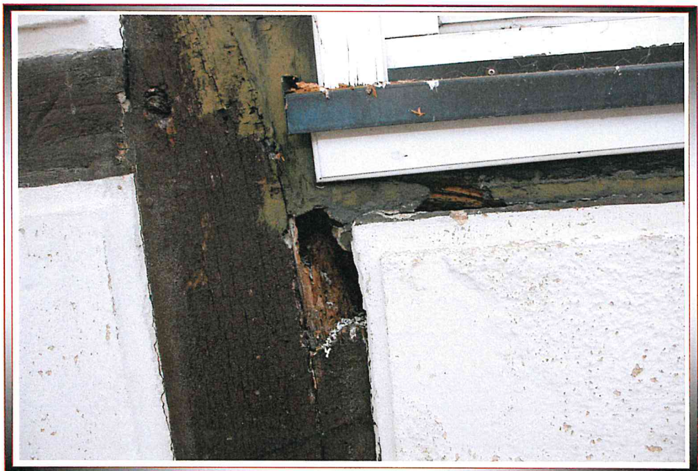
Bild 35 Fehlstellen an Zapfenlöchern des Fachwerkstiels
