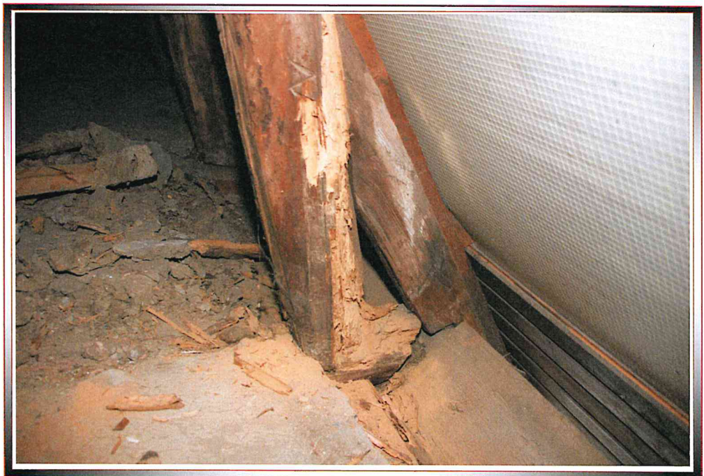
Bild 15 Hausbockschäden am Balkenkopf und Sparrenfuß
