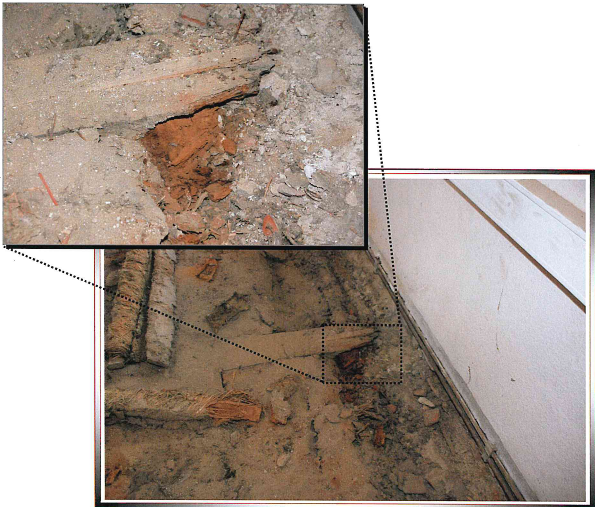
Bild 3 Durch Braunfäule geschädigter Stichbalken
