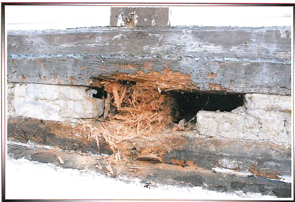
Bild 38 Weißfäuleschäden am Balkenkopf und Mauerlatte/Schwelle
