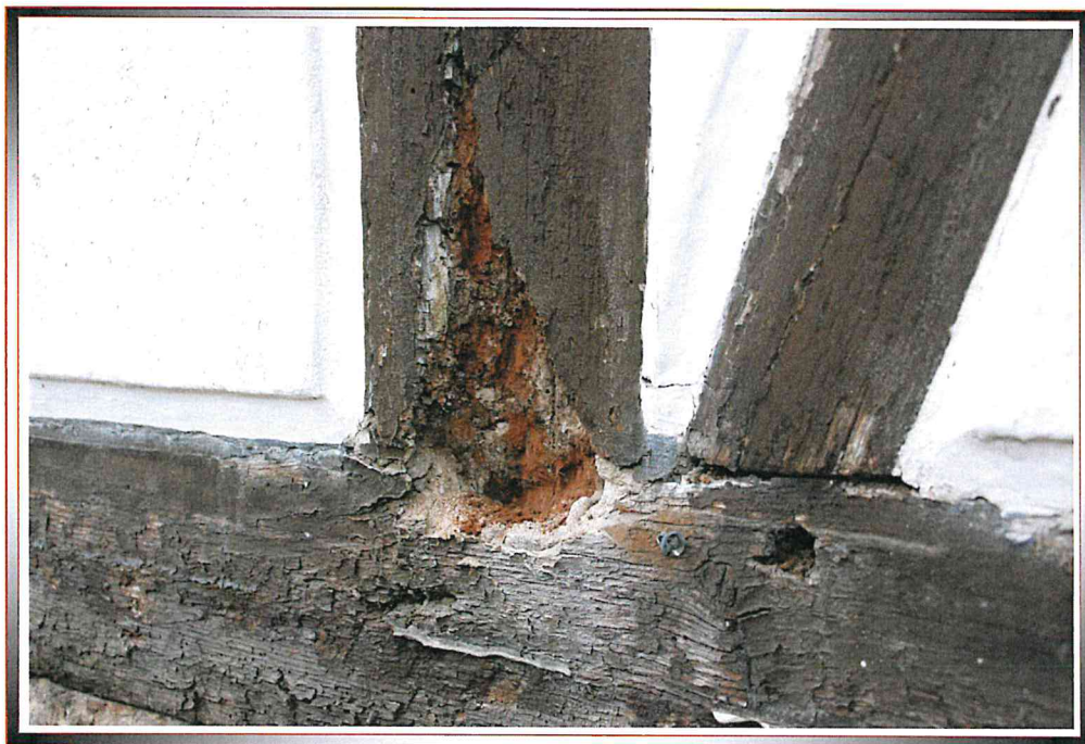
Bild 37 Geschädigter Fuß von einem Fachwerkstiel
