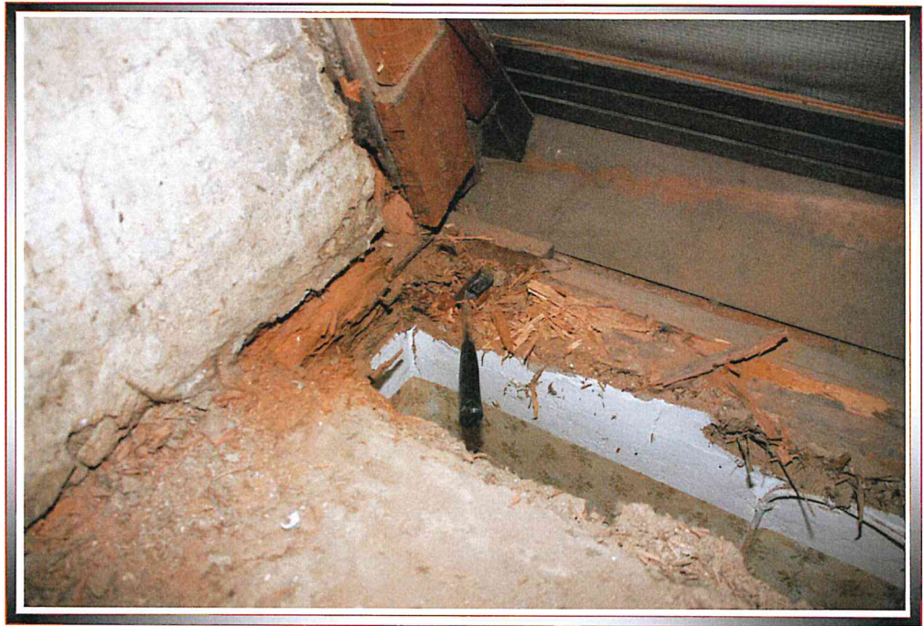
Bild 14 Fäulnisschäden am Rähm und dem Balkenkopf
