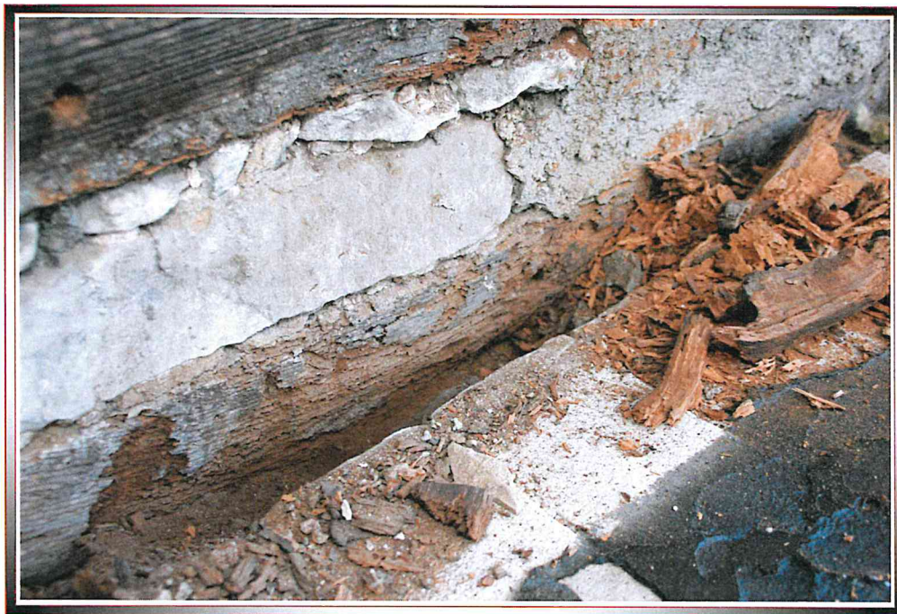
Bild 39 Falsche Aufmauerung vor einer Mauerlatte
