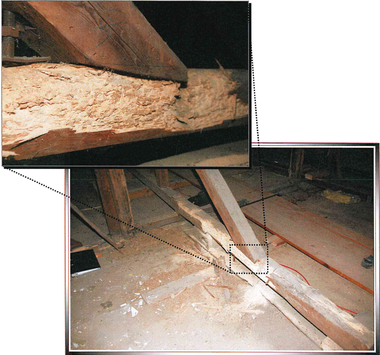
Bild 28 Hausbockschäden am Einfachen Hängewerk
