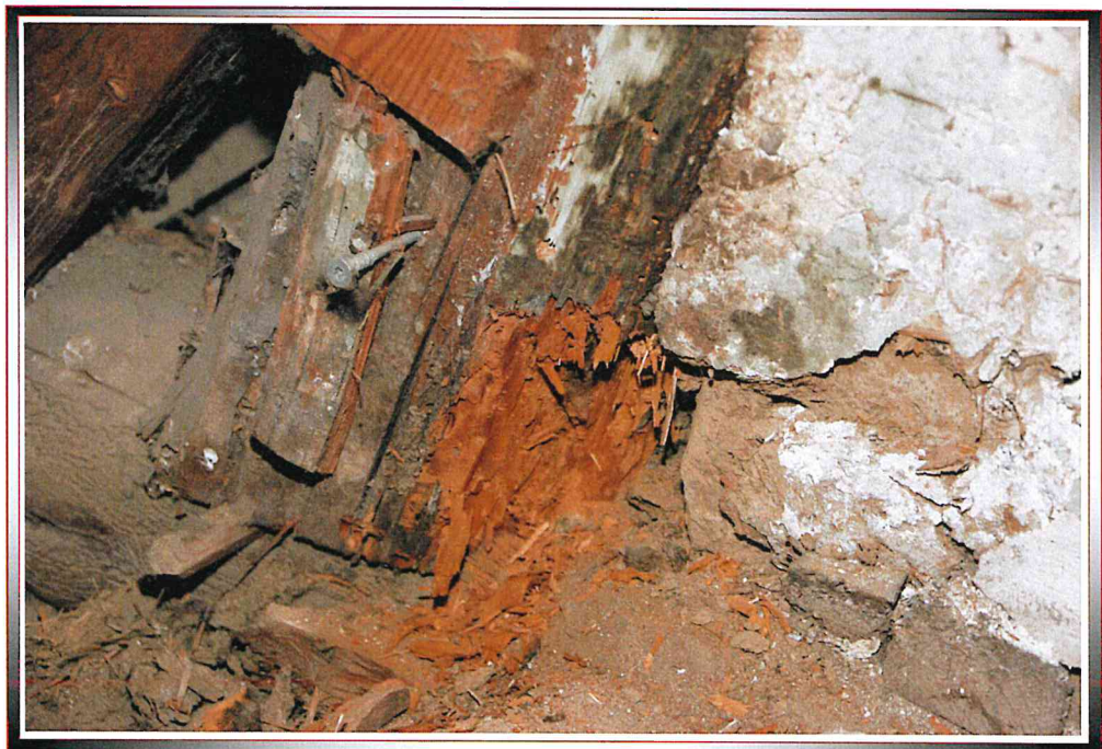
Bild 11 Fäulnis- und Insektenschäden am Sparrenfuß
