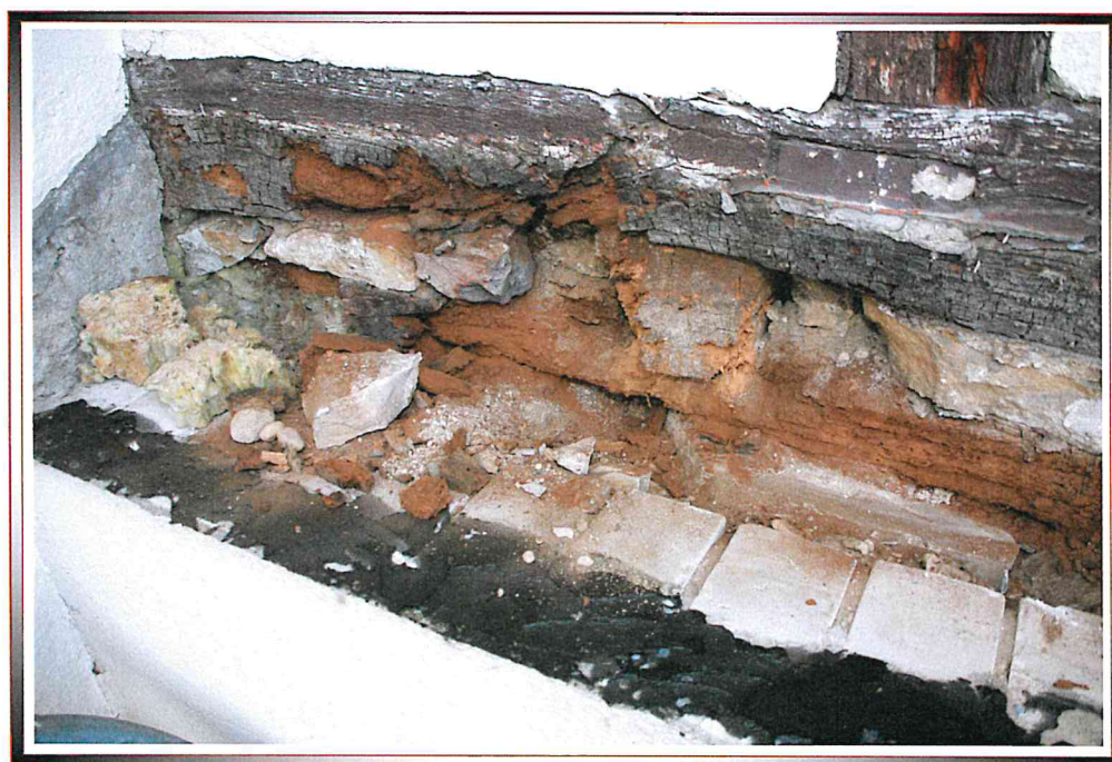
Bild 42 Umfangreiche Insekten- und Pilzschäden an Mauerlatte und Schwelle
