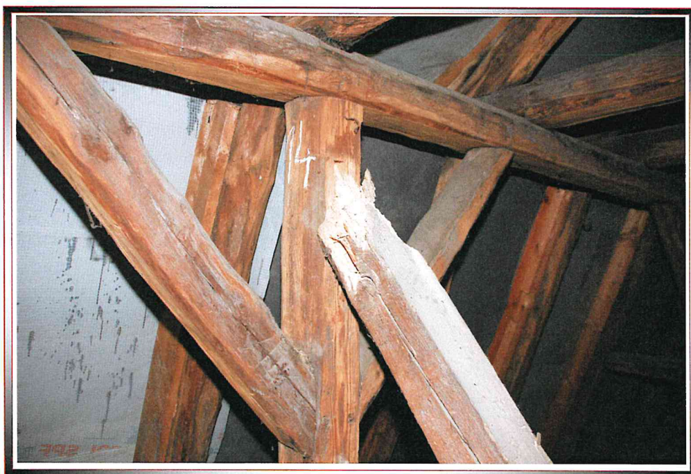
Bild 27 Strebe in Achse 14 mit Hausbockschäden
