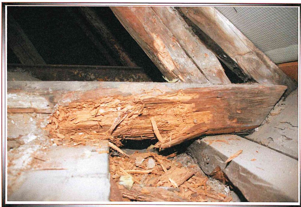
Bild 23 Weißfäule an der Flanke vom Balkenkopf
