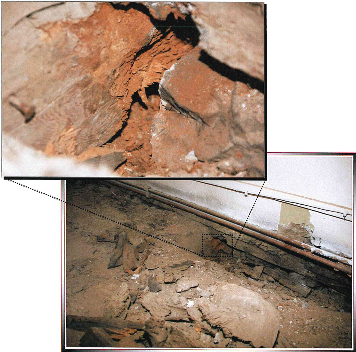
Bild 4 Balkenkopfschäden auf der Nordseite
