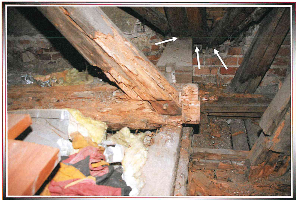
Bild 20 Zerstörter Knotenpunkt (Vordergrund) und Schäden an Kehlsparren (Pfeil)
