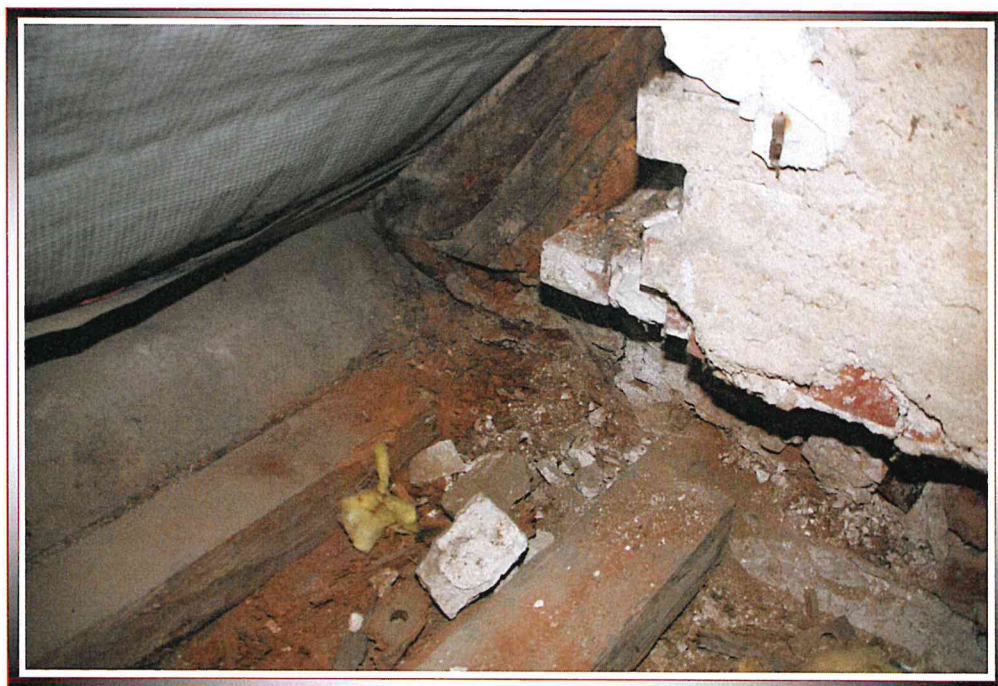
Bild 24 Fäulnisschäden an den Mauerlatten am Giebelmauerwerk
