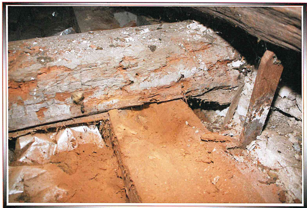
Bild 26 Balkenquerschnitt zu ca. 50 % geschädigt
