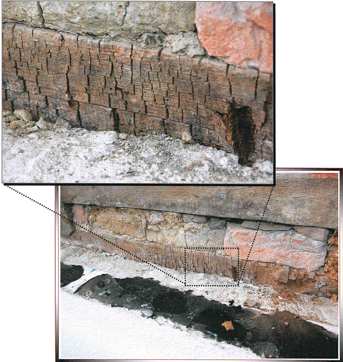
Bild 40 Fäulnisschäden an der Mauerlatte, Schwelle fast schadfrei
