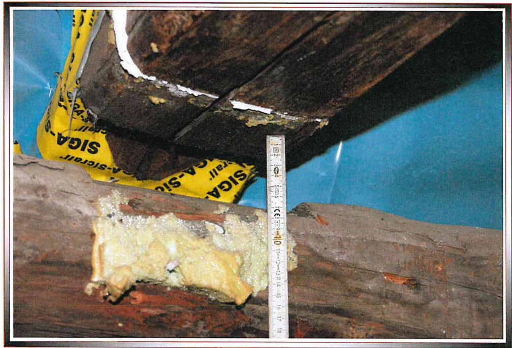
Bild 30 Gelöste Verbindung zwischen Rähm und Kehlbalken
