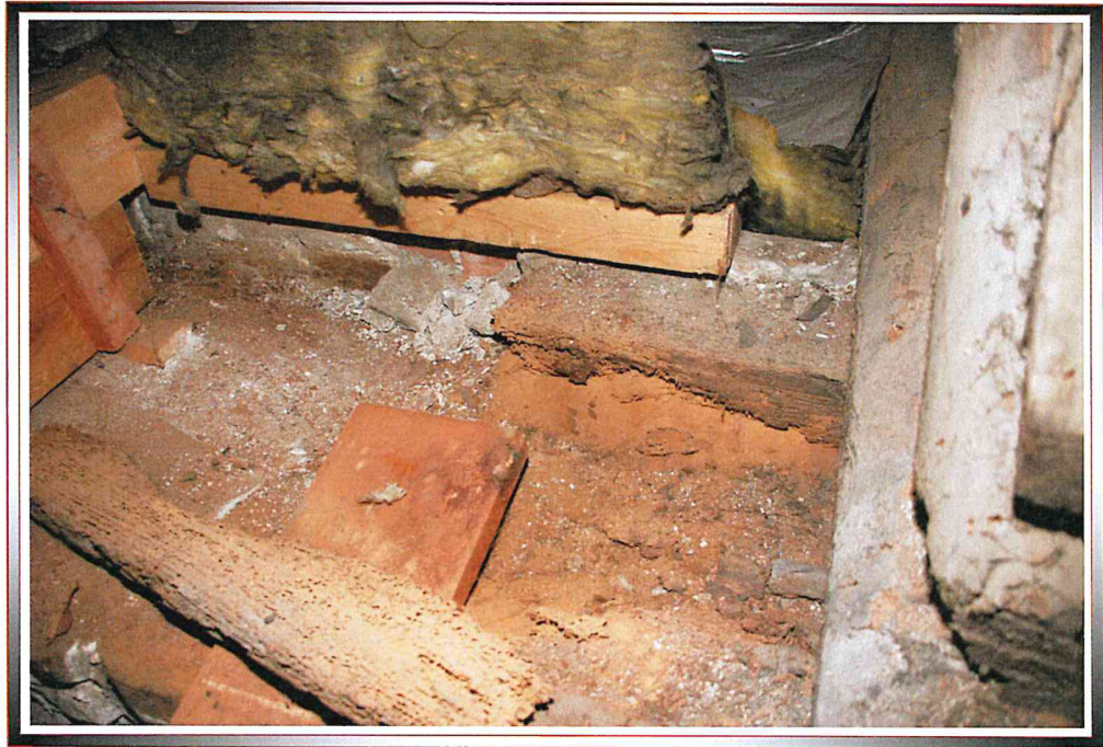
Bild 18 Mauerlatten, die nicht mehr vorhanden sind
