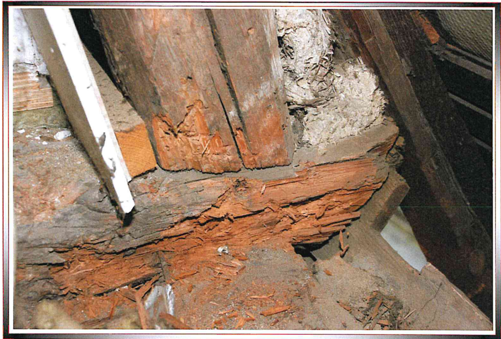
Bild 16 Oberflächenschäden an der Holzkonstruktion neben Treppenhaus
