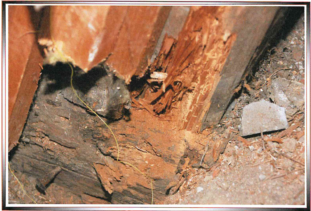
Bild 8 Insektenschäden am Sparrenfuß in Achse 16
