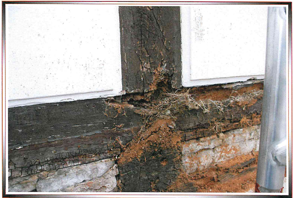
Bild 34 Fachwerkstiel ohne ausreichenden Aufstand
