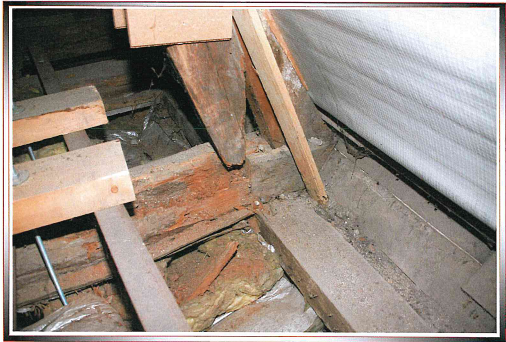
Bild 7 Zerstörter Balkenkopf in Achse 11
