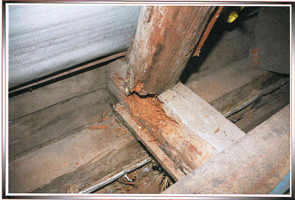
Bild 5 Geschädigter Balkenkopf in Achse 3
