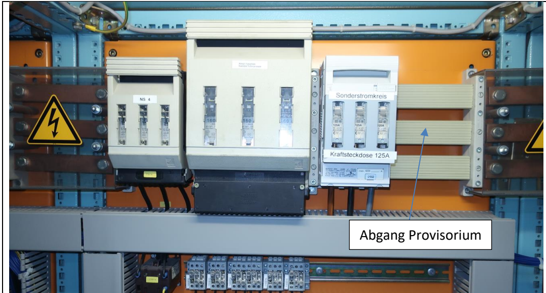
Schaltanlage SEA-NS-4 im EMSR Raum Schlammmentwässerung
