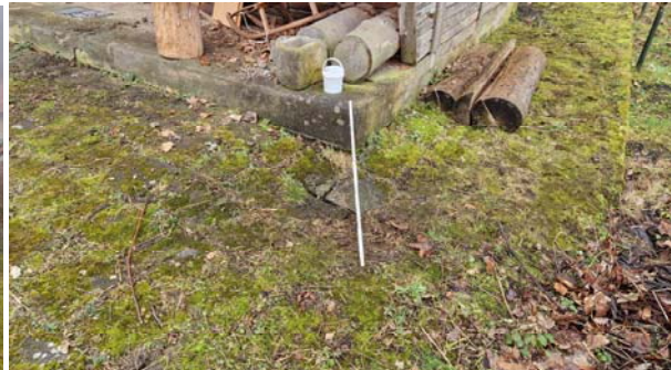
Bild 2 – Sackungen am Bestandsbungalow Nordostecke
