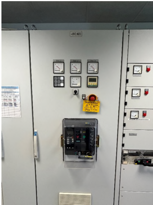
Abbildung 4-2: Abgangsfeld BHKW 2 mit Leistungsschalter
