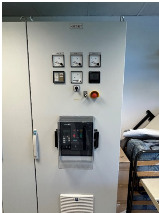
Abbildung 4-3: Abgangsfeld BHKW 1 mit Leistungsschalter
