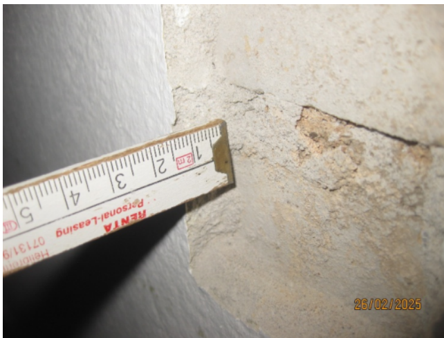
Abb. 15: BV „Neues Rathaus Dresden“. Putzprobe 1.OG, 26.02.2025
