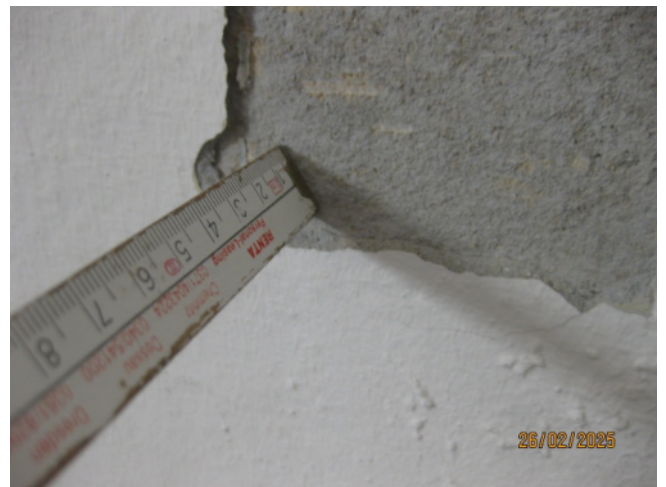
Abb. 22: BV „Neues Rathaus Dresden“. Putzprobe 4.OG, 26.02.2025
