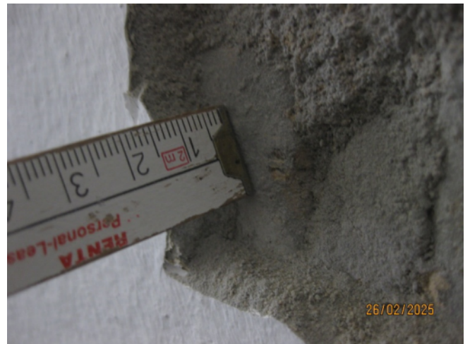
Abb. 18: BV „Neues Rathaus Dresden“. Putzprobe 2.OG, 26.02.2025
