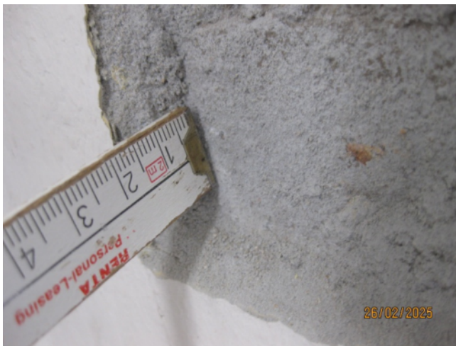
Abb. 21: BV „Neues Rathaus Dresden“. Putzprobe 4.OG, 26.02.2025
