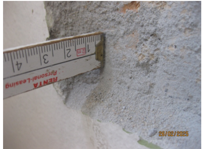
Abb. 20: BV „Neues Rathaus Dresden“. Putzprobe 3.OG, 26.02.2025
