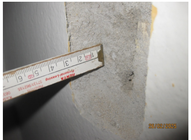
Abb. 16: BV „Neues Rathaus Dresden“. Putzprobe 1.OG, 26.02.2025
