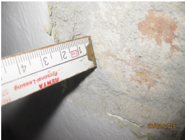
Abb. 17: BV „Neues Rathaus Dresden“. Putzprobe 2.OG, 26.02.2025
