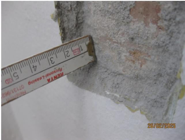
Abb. 19: BV „Neues Rathaus Dresden“. Putzprobe 3.OG, 26.02.2025
