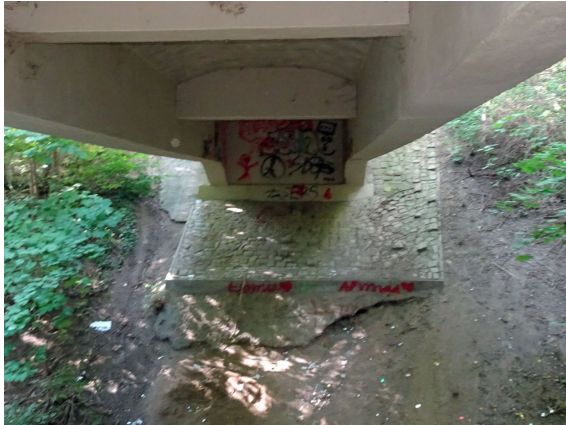
S21 AUSKOLKUNG WL HINTEN LINKS
