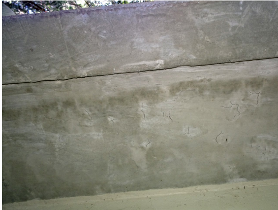
S51 KRAGARM BETONERSATZ RISSIG
