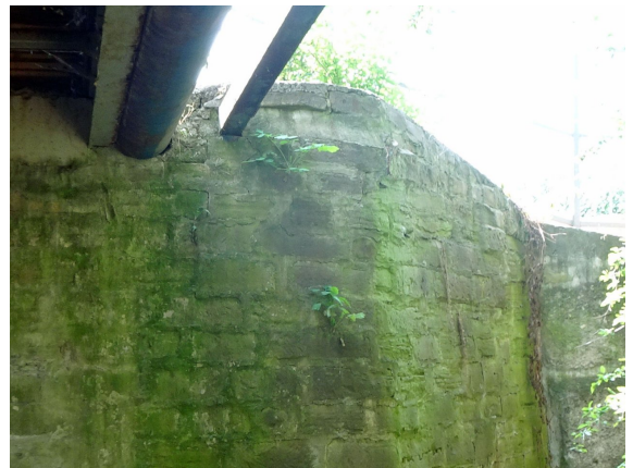
S35 WDL NATURSTEINMAUERWERK BEWUCHS AUS DEN FUGEN
