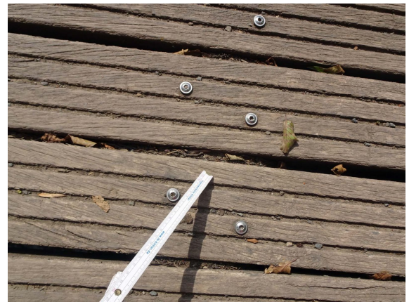
S33 SCHMUTZABLAGERUNG ZWISCHEN BOHLENBELAG
