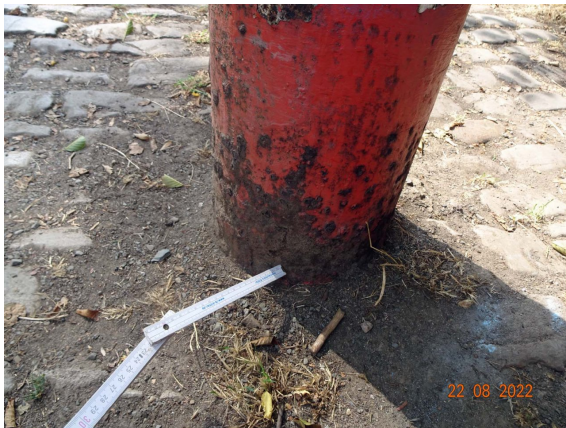
S29 ABGEPLATZTE BESCHICHTUNG
