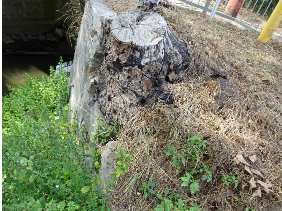
S41 BAUMSTUMPF FLÜGELWAND HINTEN RECHTS
