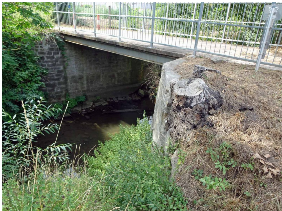
S40 GELÄNDER NICHT AN ABSTURZKANTE
