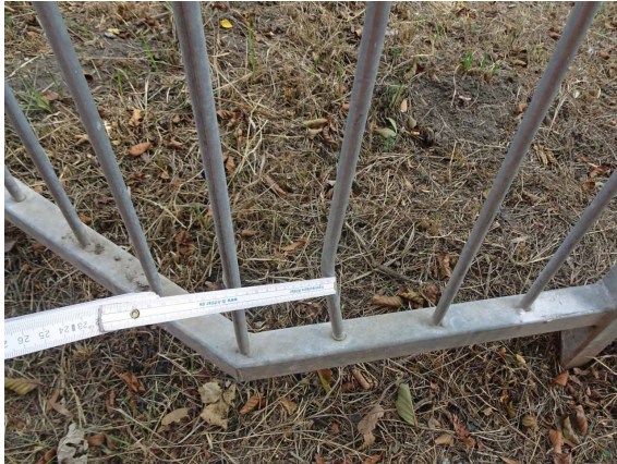
S42 GELÄNDERSTREBE BESCHÄDIGT
