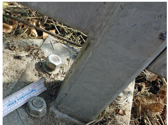
S37 GELÄNDER VERBUNDANKER NICHT KRAFTSCHLÜSSIG GESICHERT
