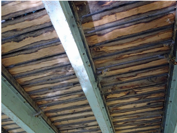
S13 ÜBERBAUUNTERSICHT LÄNGSTRÄGER ANGEROSTET
