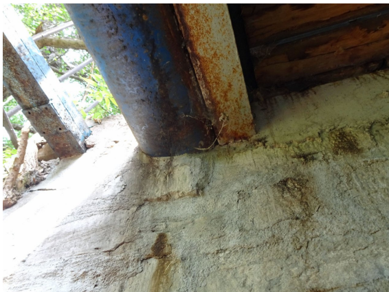
S34 ÜBERBAUUNTERSICHT LÄNGSTRÄGER VERROSTET
