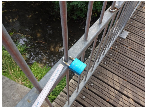
S32 KORROSIONSCHUTZ NICHT GEWÄHRLEISTET
