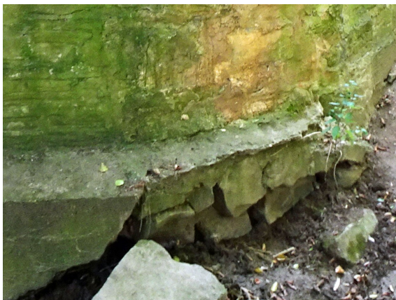
S26 KOLKSCHUTZ GEBROCHEN
