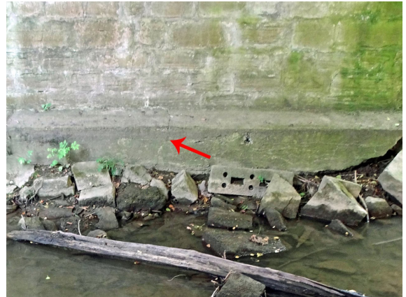
S12 KOLKSCHUTZ GERISSEN
