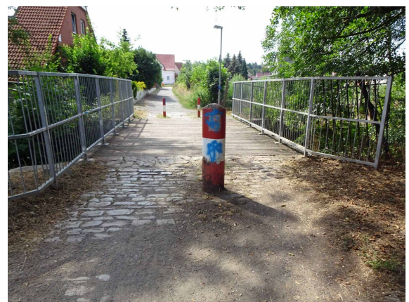
S02 PFLASTERUNG UNEBEN HINTER DEM BAUWERK
