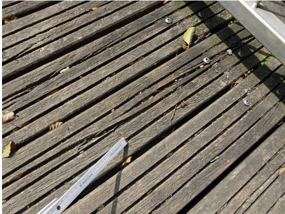
S30 BOHLENBELAG GERISSEN
