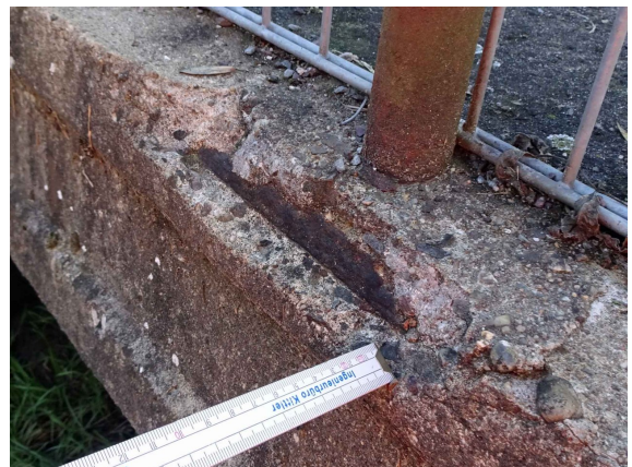
S38 FREILIEGENDE BEWEHRUNG AN STIRNSEITE LINKS
