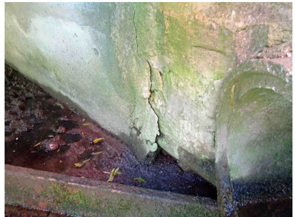
S21 ABPLATZUNG IM BEREICH WDL - STÜTZWAND
