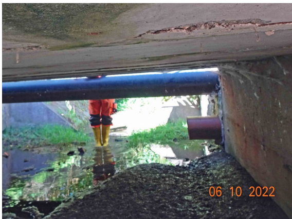
S20 SCHLAMMABLAGERUNG UNTER BW
