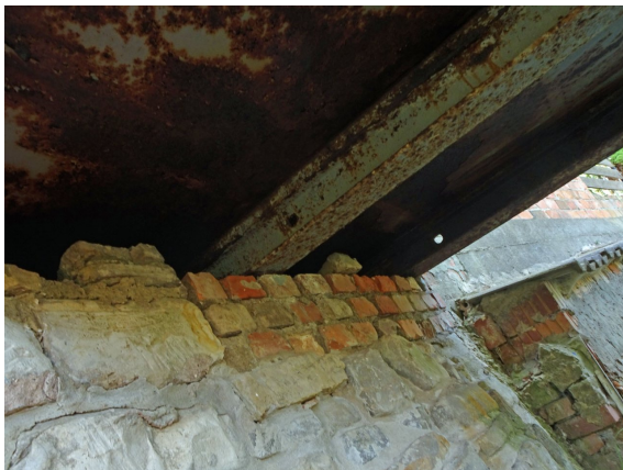
S07 WL MAUERWERKSFUGEN GERISSEN
