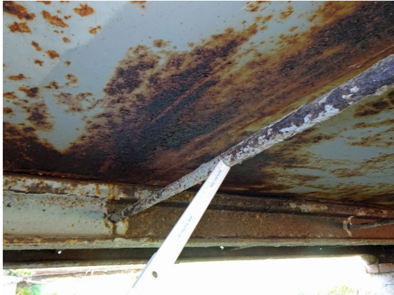
S05 ÜBERBAUAUSSTEIFUNGEN VERROSTET
