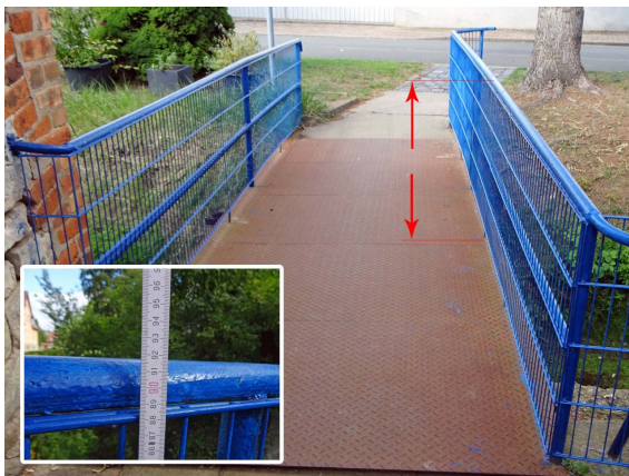
S03 GELÄNDER ZU GERING IN DER HÖHE
