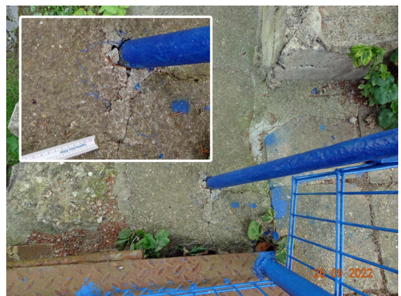
S13 FLÜGELWAND UM GELÄNDERPFOSTEN GERISSEN
