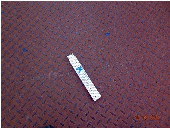
S01 RIFFELBLECH ANGEROSTET
