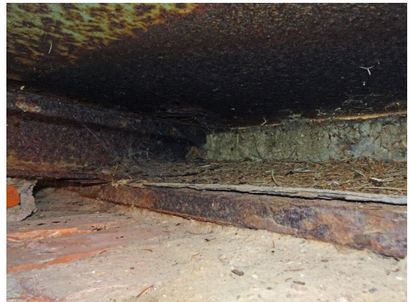
S12 AUFLAGERBANK SCHMUTZABLAGERUNG
