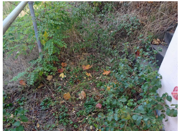
S51 BEWUCHS UNTERHALB DES BAUWERKS
