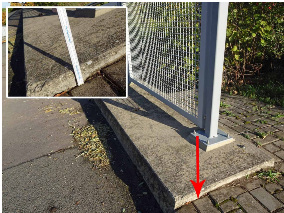
S27 PFLASTERUNG ABGESACKT
