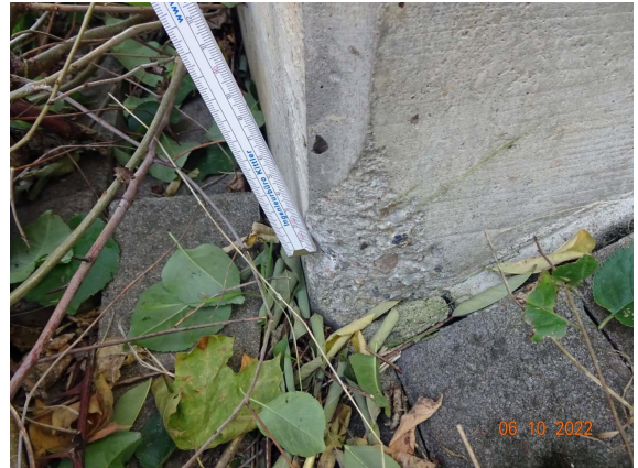
S15 WIDERLAGERECKE ABGEPLATZT
