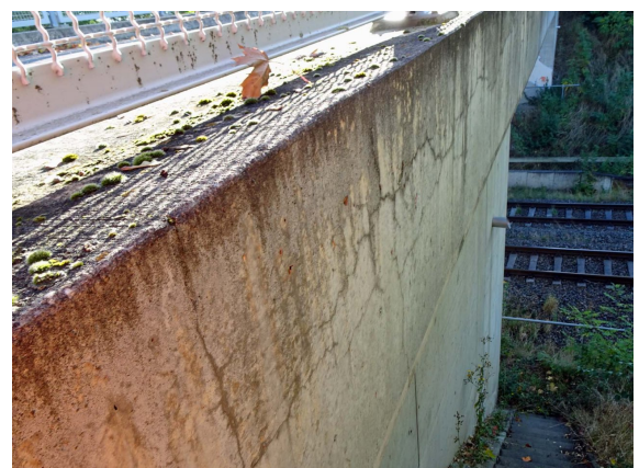
S38 FLÜGELGESIMS LÄNGSRISSE
