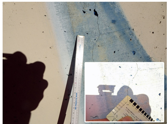
S06 WIDERLAGER VORN LÄNGSRISS
