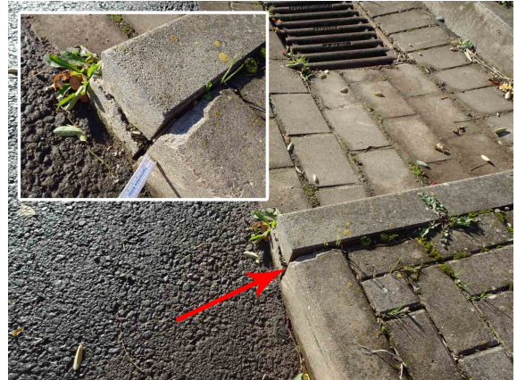
S50 KANTENSTEIN GEBROCHEN
