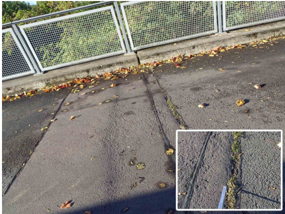
S33 FAHRBAHNBELAG ÜBERGÄNGE UNEVEN_SCHADHAFT
