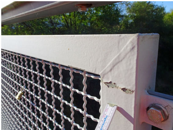
S52 DRAHTGITTERRAHMEN BESCHICHTUNG ABGEPLATZT
