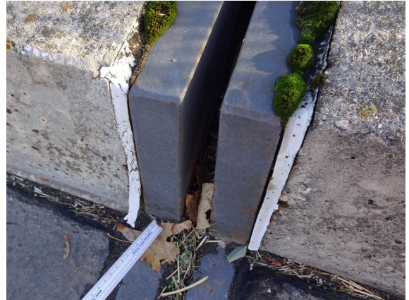
S35 FUGENMATERIAL LÖST SICH
