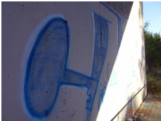
S23 WIDERLAGER MIT GRAFFITI
