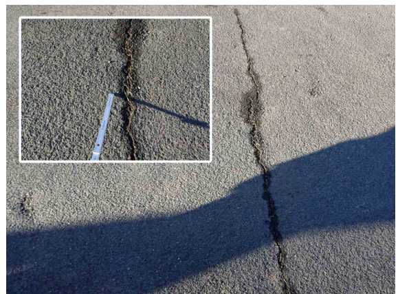
S45 BELAG MITTE GERISSEN
