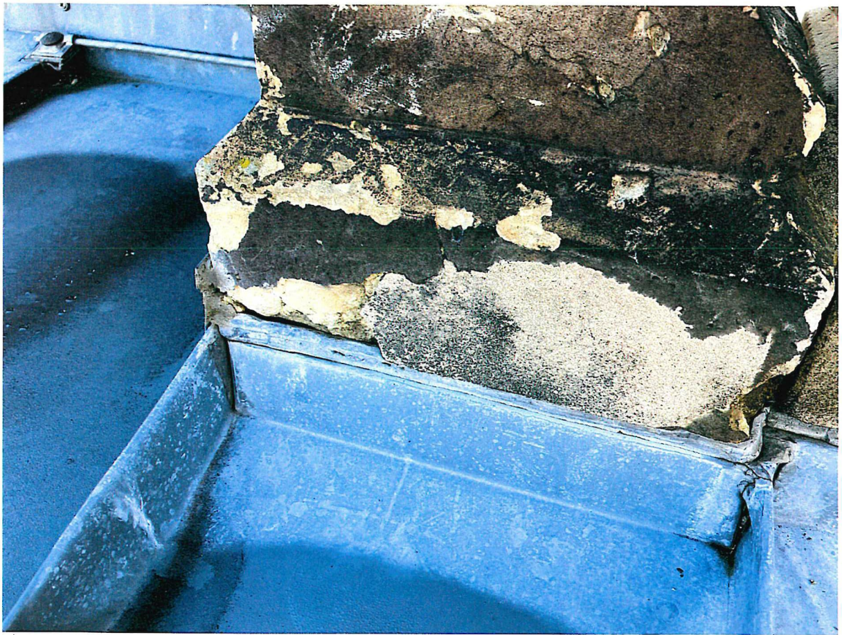
Verblechung intakt, Sandsteinfugen offen
