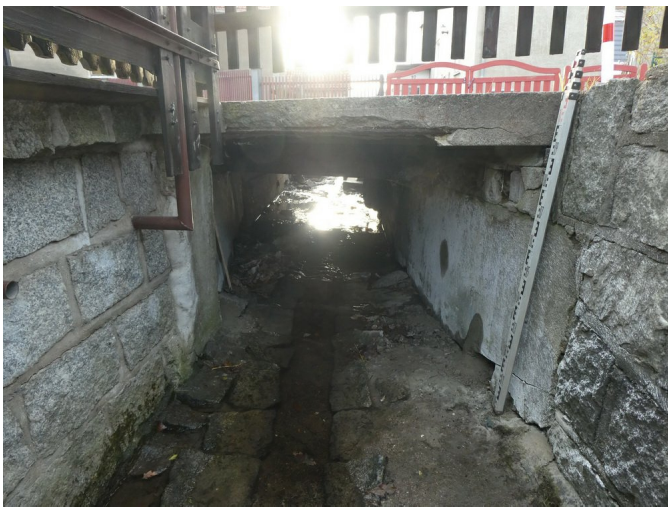
Übersicht Durchlass Unterstrom, Überbau mit starken Betonausplatzungen und freiliegender Bewehrung
