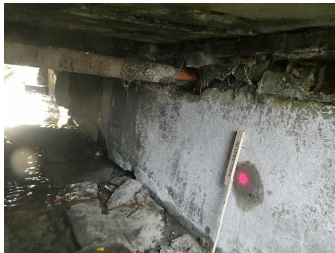
Widerlager Hauptstraße, Lage KB2 und beschädigte Leitungsunterführung, Auskolkung im Sohlbereich
