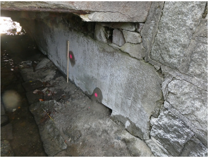
Widerlager Hauptstraße, Lage KB2 und KB4, Auskolkung, maroder Zustand im Auflagerbereich
