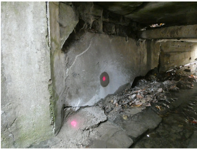
Widerlager Niederstraße, Lage KB1 und KB3, Auskolkung, maroder Zustand im Auflagerbereich
