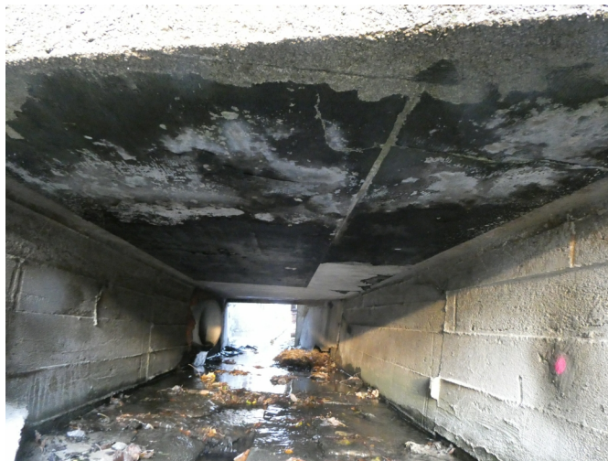
Unterseite des Überbaus mit Salzausblühungen und sich ablösender Beschichtung, Rohrauslass im Widerlager Hauptstraße
