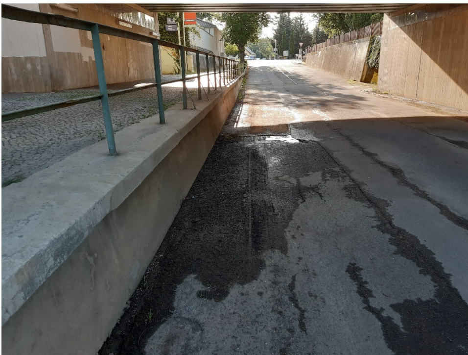
Bild 2 Standwasserflächen unter der Brücke trotz trockener Witterung
