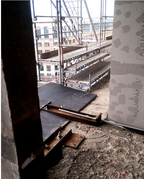
Abbildung 11: Pos 3..30 – optische Sicherung und Nachspannen Zugband Ringanker
