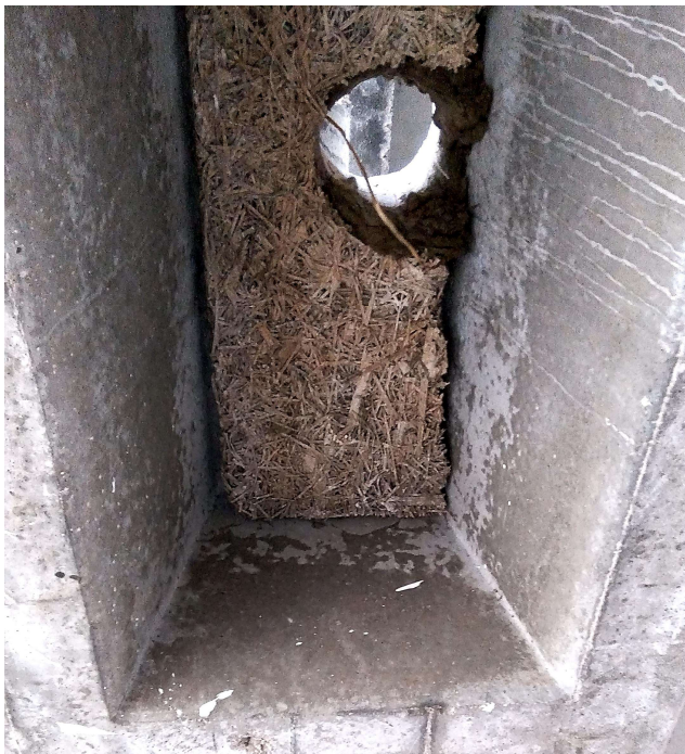
Abbildung 12: Pos. 3..40 – Sicherung poröser Unterzüge
