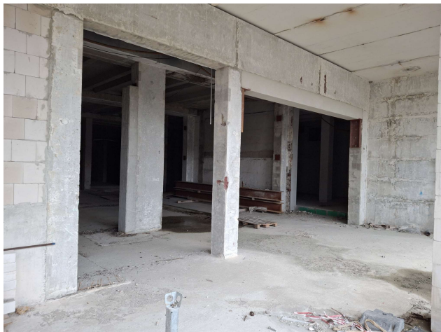
Abbildung 2: Pos. 1..10 – offene Zugänge im rückwärtigen Kellergeschoss
