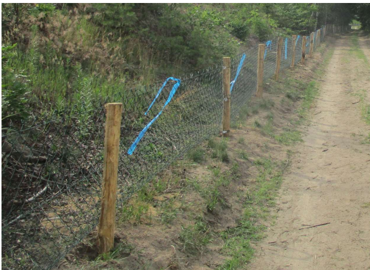
Beispiel eines aufgebauten Schutzzaunes mit kunststoffummanteltem Maschendrahtgeflecht südöstlich Sprey
