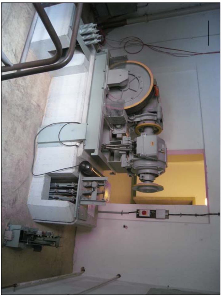
Ansicht Maschinenraum – Antrieb
